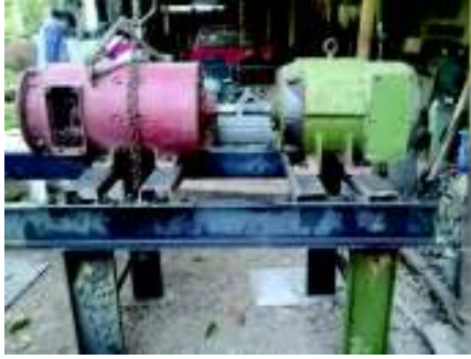
Figura 3.5 Grupo motor-generator alineado
