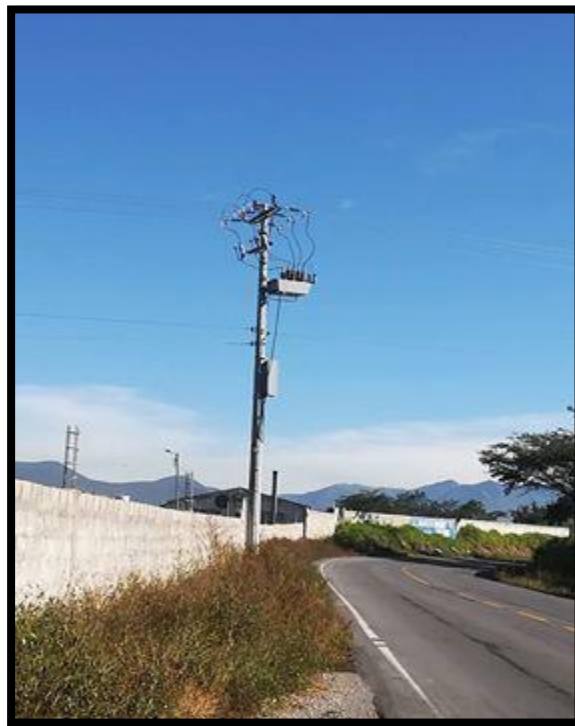
Figura 5.2 Reconector R000394 ubicado en el sector La Josefina
