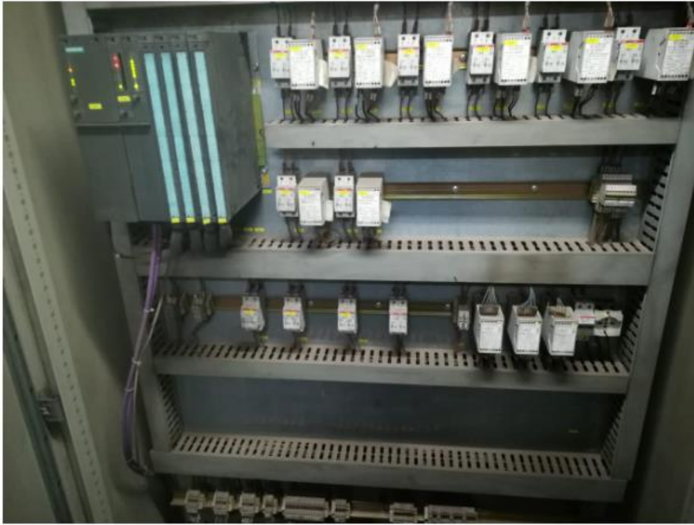
Figura 3.2. Tablero de control.
