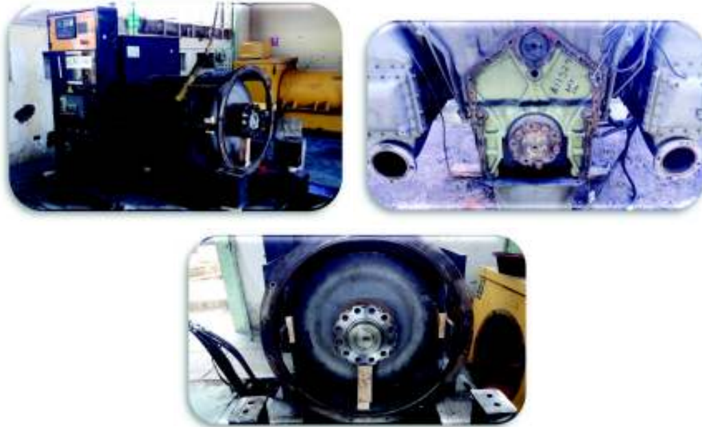
Figura 2.1: Grupo térmico Perkins PS1386E desarmado, a) Generador sincrónico, b) Motor de combustión interna (eje del cigüeñal), c) Eje del rotor
