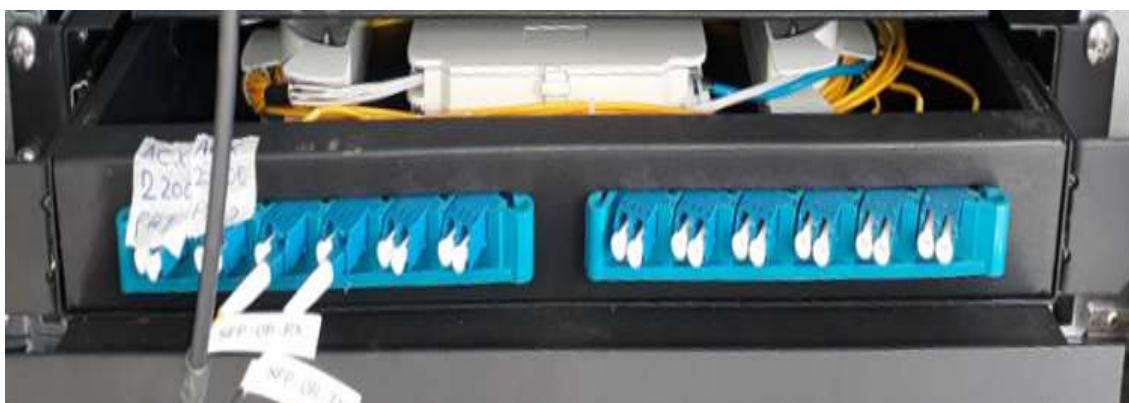
Figura 3.21. ODF con terminales LC
