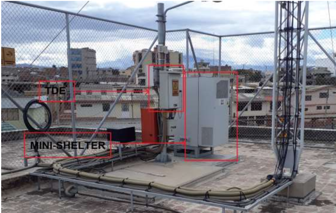
Figura 3.17. Mini-Shelter con los equipos de la estación base
