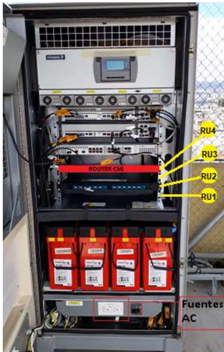
Figura 3.19. Ubicación del router CSG
