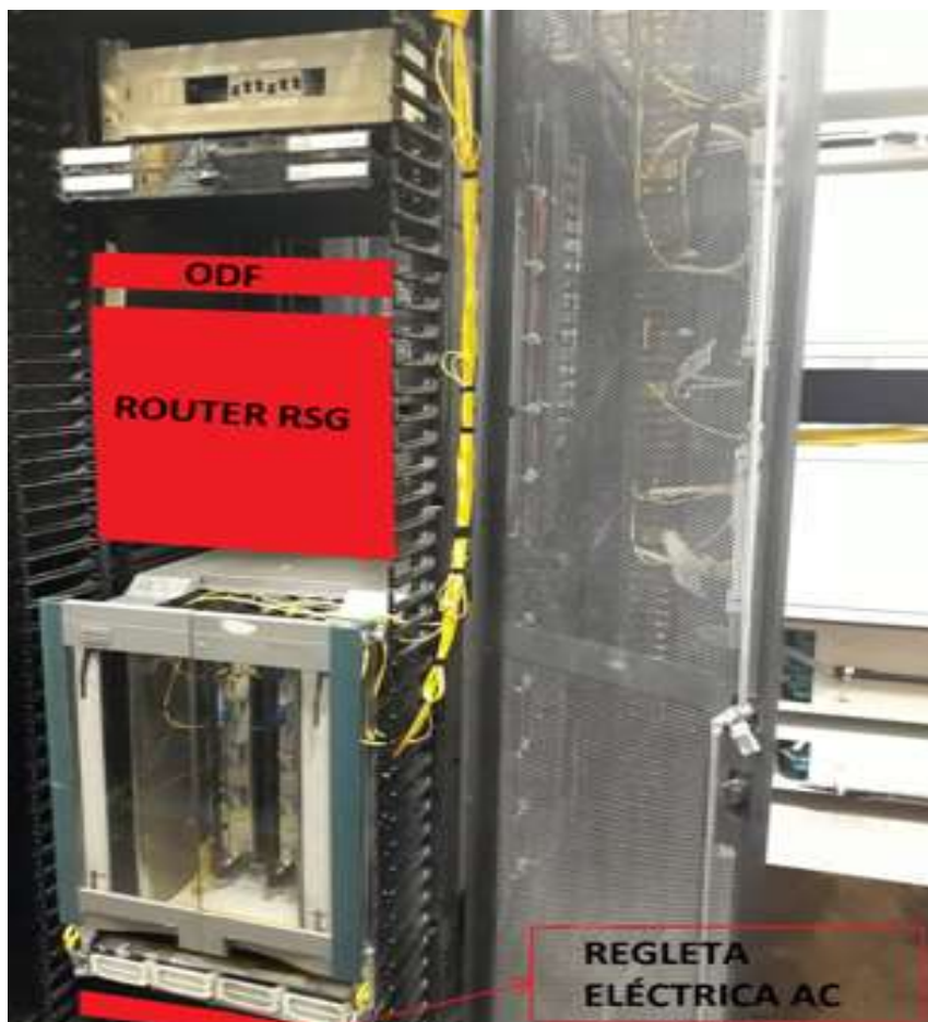
Figura 3.24. Ubicación del router RSG
