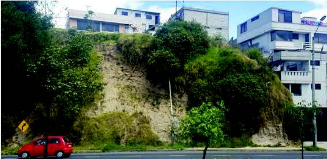
Fotografía A. 15 Capas afectadas por erosión superficial e inadecuado sistema de drenaje.
