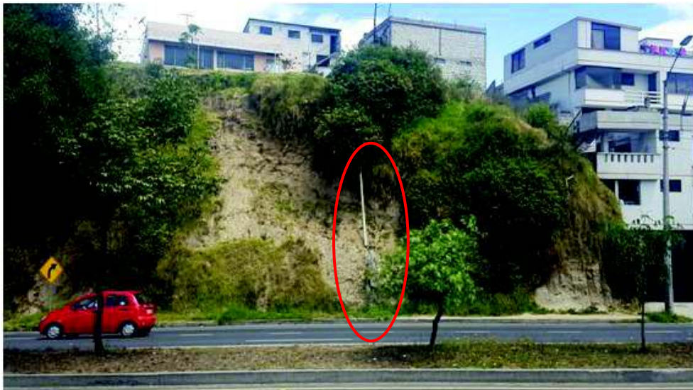
Fotografía 1. 2 Descarga directa de agua al pie de talud. UTM: X: 779355, Y: 9974337.5.
