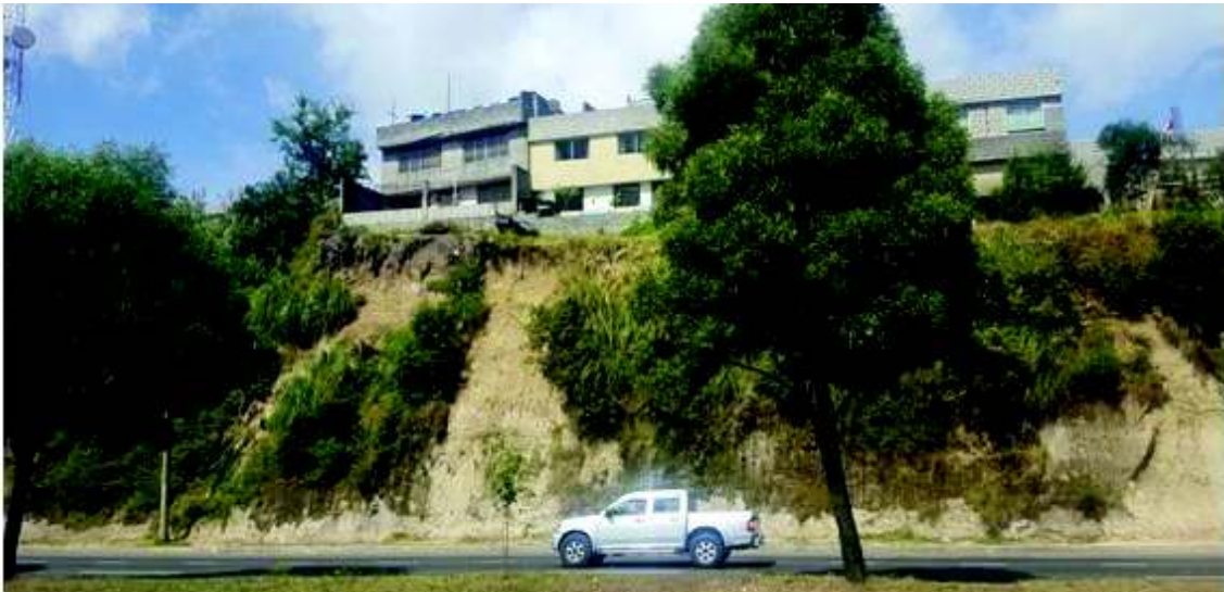
Fotografía A. 10 Capas afectadas por erosión superficial por lluvia, viento y mal manejo de drenaje, columna C10.
