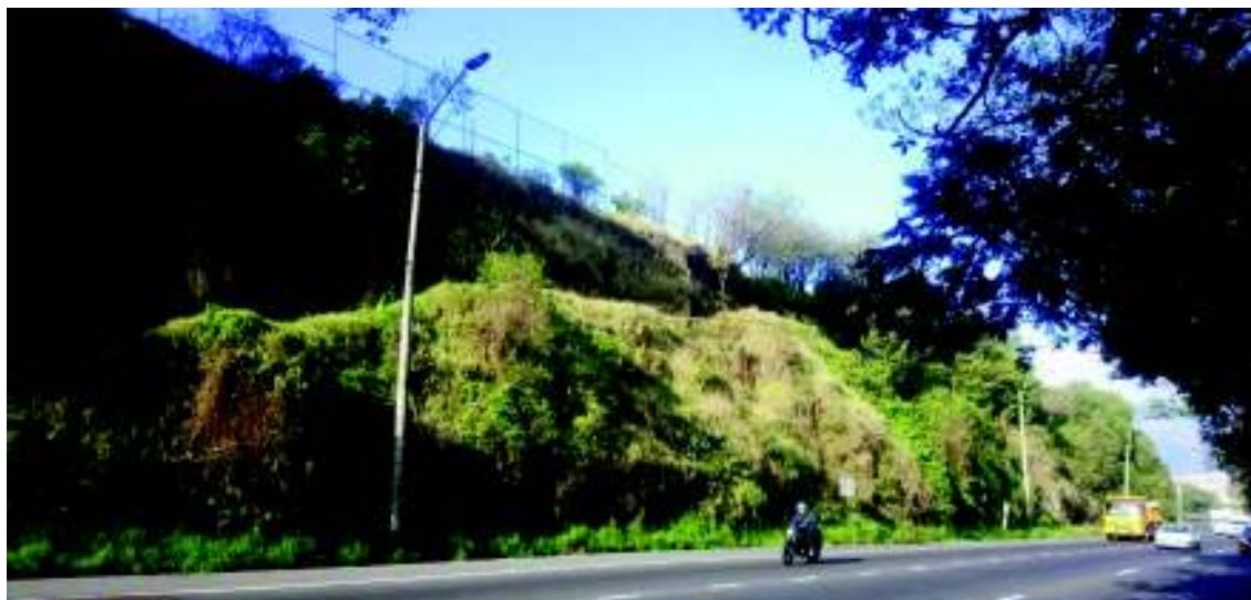
Fotografía A. 4 Estratos con presencia de erosión superficial por lluvia, viento y meteorización por acción de las raíces de los árboles.
