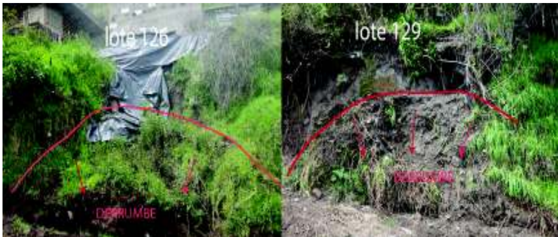
Fotografía 4.2 Derrumbes en lotes 126 y 129
