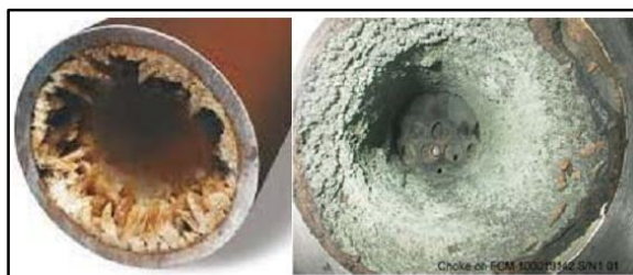
Figura 1.10: Acumulación de incrustaciones interior de la tubería y choke Fuente: (Stanko, 2017).
