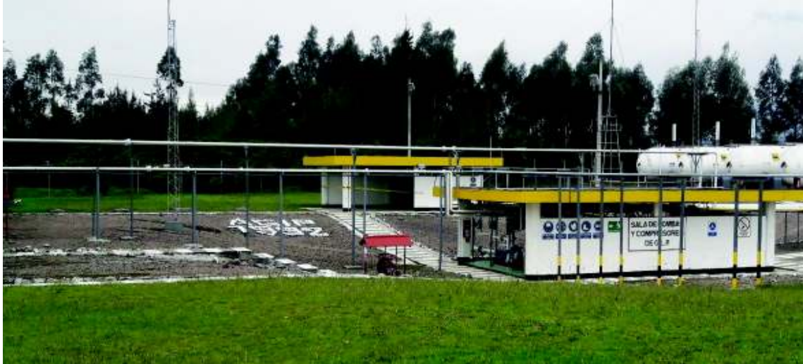
Figura 1.6. SISTEMA DE BOMBAS-COMPRESORES EN UNA PLANTA DE ALMACENAMIENTO Y ENVASADO DE GLP.
