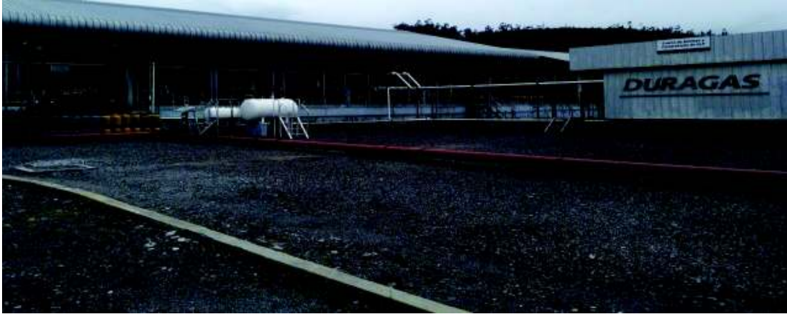
Figura 1.8. SISTEMA DE TUBERÍAS CONTRA INCENDIOS EN UNA PLANTA DE ALMACENAMIENTO Y ENVASADO DE GLP
