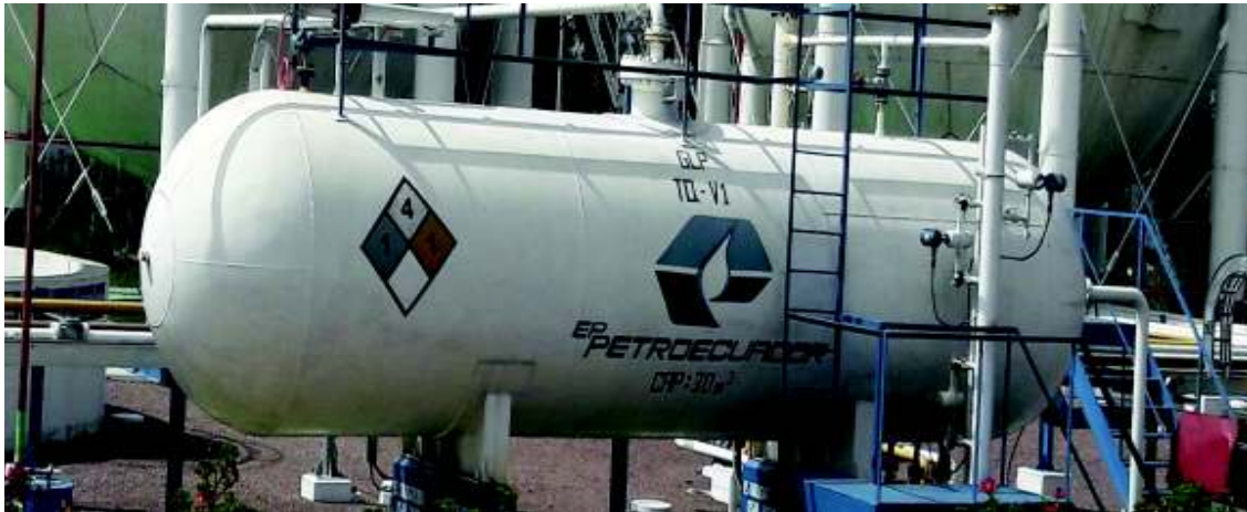
Figura 1.1. TANQUE ESTACIONARIO HORIZONTAL PARA EL ALMACENAMIENTO DE GLP
