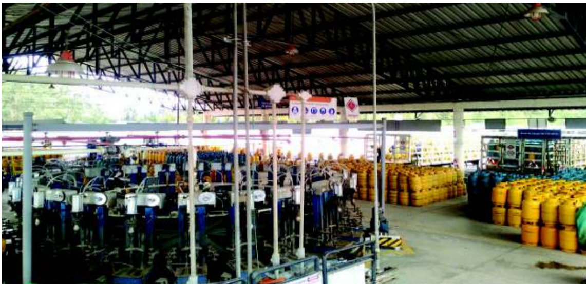
Figura 1.7. CARRUSEL DE ENVASADO EN UNA PLANTA DE ALMACENAMIENTO Y ENVASADO DE GLP
