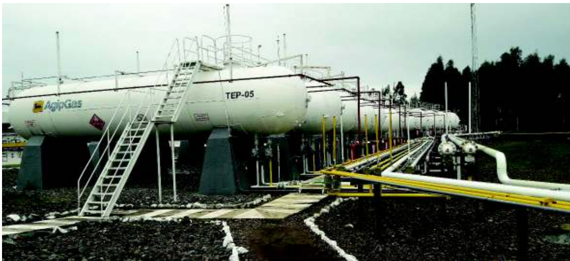
Figura 1.5. TANQUES ESTACIONARIOS EN UNA PLANTA DE ALMACENAMIENTO Y ENVASADO DE GLP
