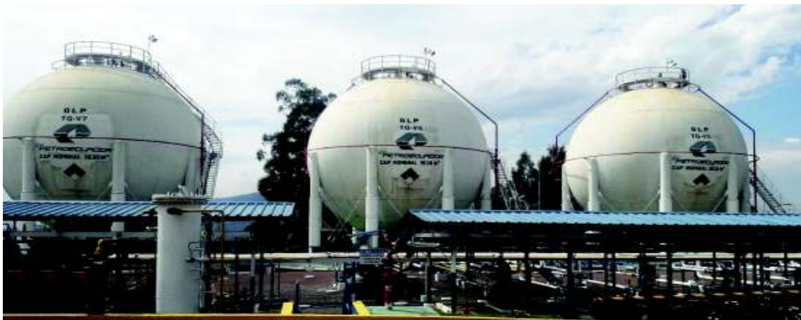
Figura 1.2. TANQUES ESTACIONARIOS ESFÉRICOS PARA ALMACENAMIENTO DE GLP
