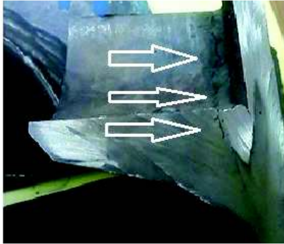
Figura 1.8. Fisuras presentes en el cordón de soldadura en una tubería de acero A 106 Gr. B. (Fuente: AUMAPROC S.A.).
