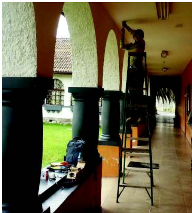
Figura 37: Instalación de cámaras ala central.
