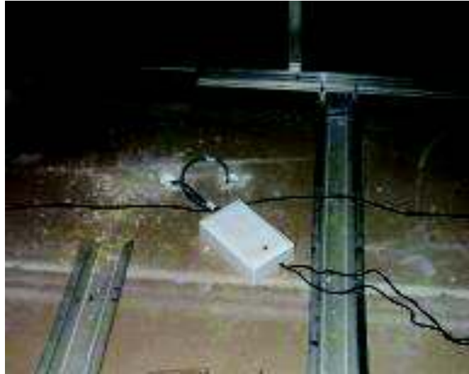
Figura 43: Caja de conexión de balun, terminal cámara, terminal cargador eléctrico.
