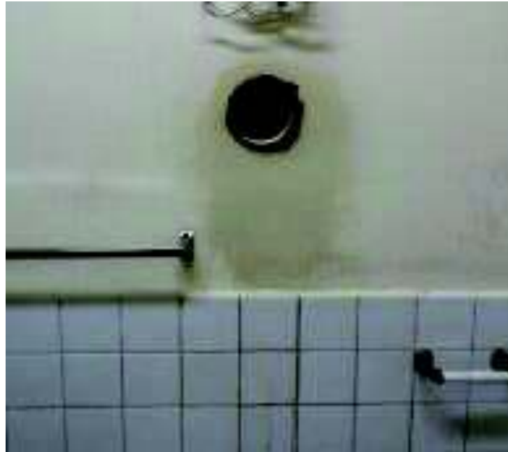
Figura 29: Vista interna de tubería acceso cuarto de equipos.
