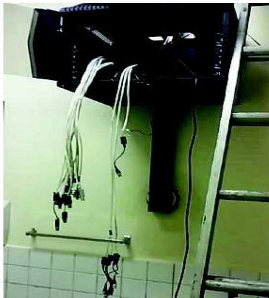
Figura 31: Rack instalado en cuarto de equipos con pase de cable UTP.
