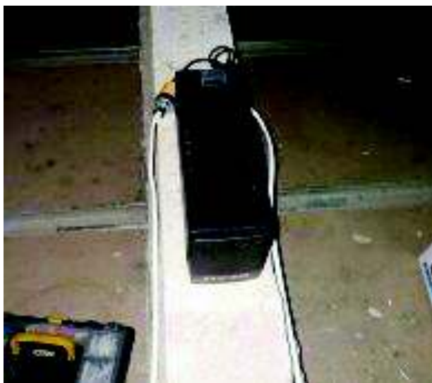
Figura 41: Instalación de UPS para alimentación eléctrica de cámaras
