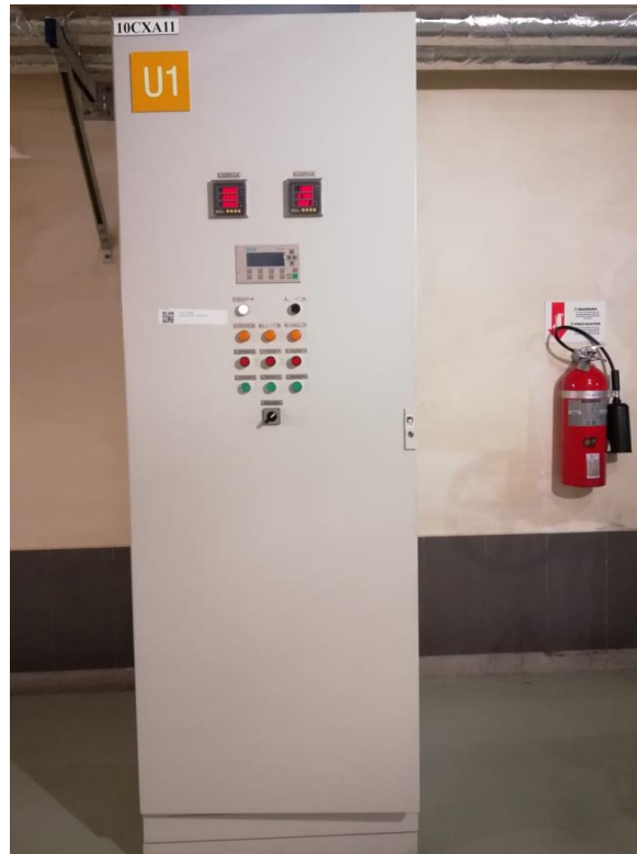
Figura 3.19. Paneles de las bombas de agua de enfriamiento en 120 V
