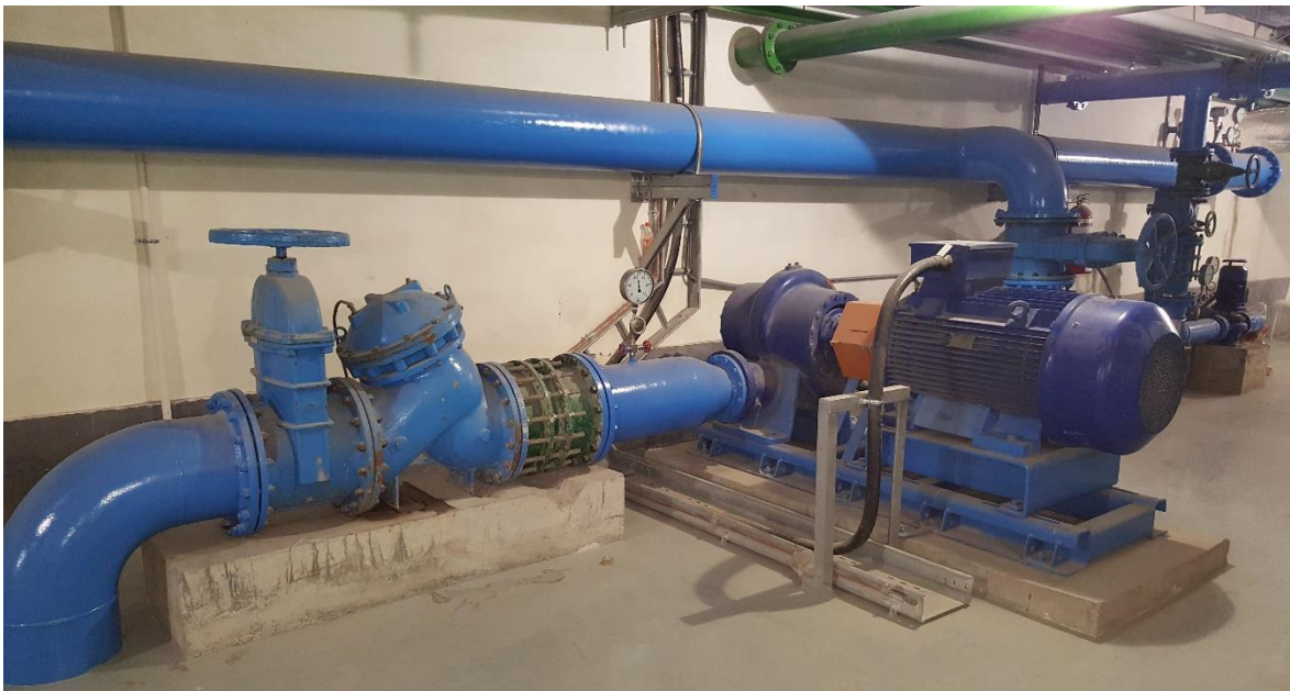
Figura 1.13. Bombas sistema de agua de enfriamiento
