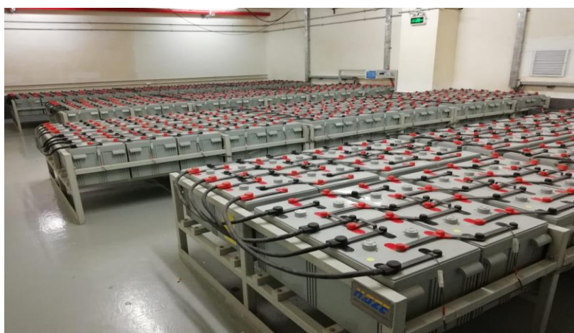
Figura 1.12. Banco de baterías casa de máquinas
