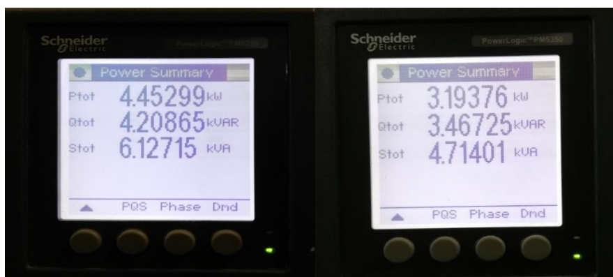
Figura 3.18. Paneles en 480 V y 220 V
