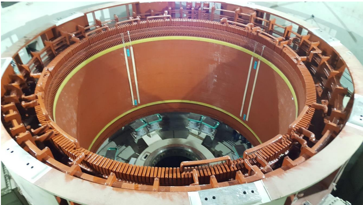
Figura 2.2. Estator del generador síncrono de Coca Codo Sinclair
