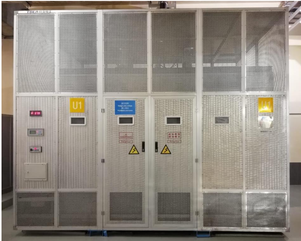
Figura 1.11. Transformador de aislamiento de la unidad 1
