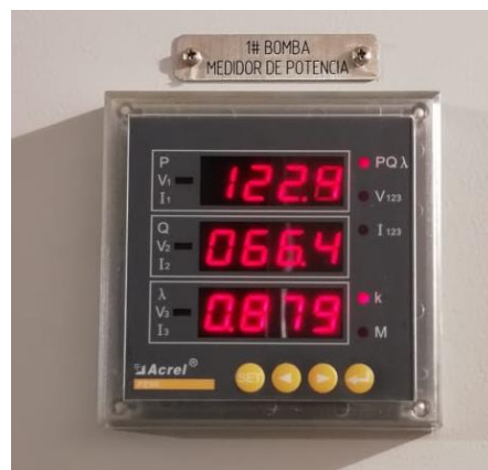
Figura 3.20. Medidor de potencia de la bomba #1 en 120 V
