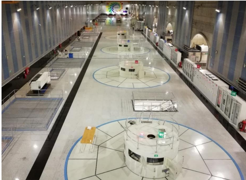
Figura 1.7. Sala de generadores de la central hidroeléctrica Coca Codo Sinclair
