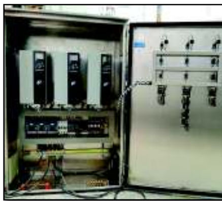
Figura 8: Tablero de Distribución Centro Comercial el Recreo
