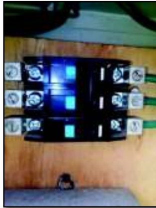
Figura 27: Breaker de 75 A conectado a contador 4287
