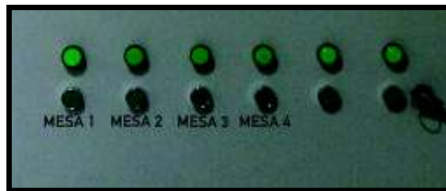
Figura A6.5. Pulsadores de Marcha ubicados en la parte inferior del tablero (exterior)
