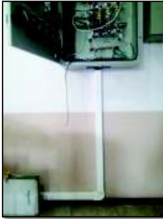
Figura 32: Canaletización de cables de circuitos derivados.
