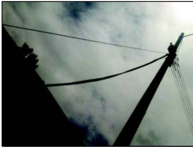
Figura 25: Acometida desde líneas de alimentación a contador 4287 de la EEQ.
