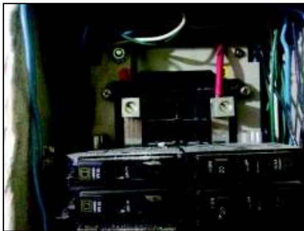
Figura 6: Alimentador de tablero de distribución de vivienda
