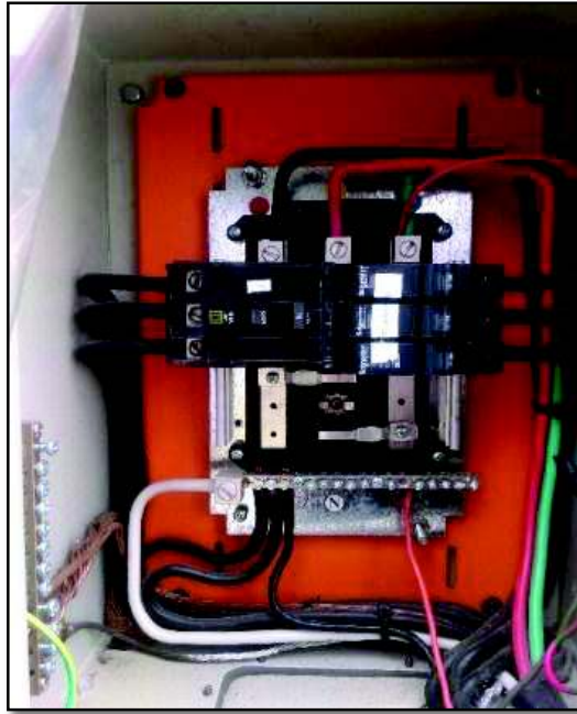
Figura 22: Breaker de 70 A en tablero de distribución.
