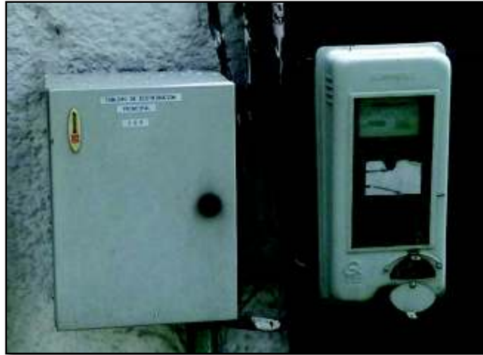
Figura 23: Contador eléctrico 76020 perteneciente a le EEQ
