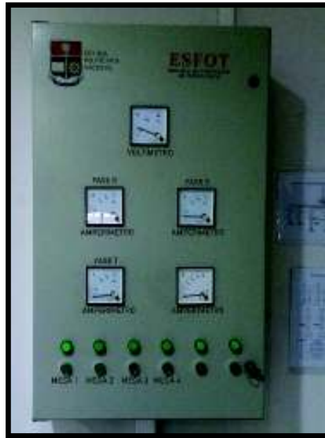
Figura 37. Tablero de distribución Laboratorio de Control y Análisis Industrial.
