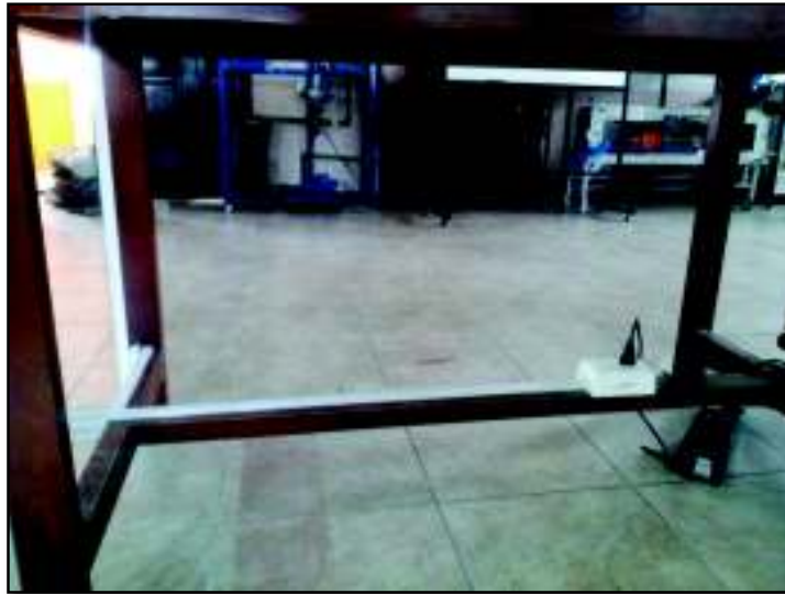
Figura 38: Tomacorriente de Mesa 1
