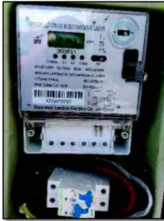
Figura 5: Contador eléctrico Londian de EEQ
