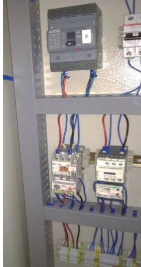
Figura 17. Conexión de contactores y guardamotores
