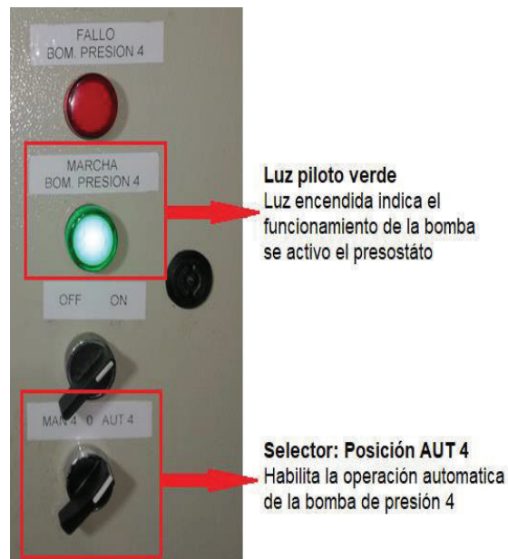
Figura 26. Operación automática de la bomba de presión 4
