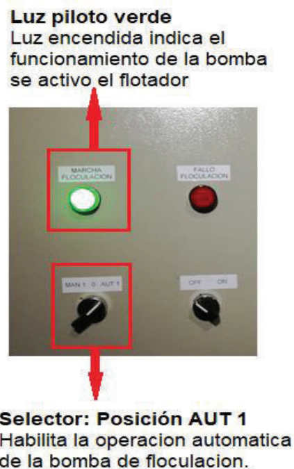
Figura 23. Operación automática de la bomba de floculación
