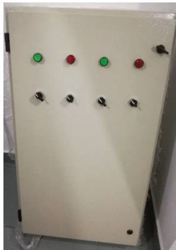
Figura 14. Distribución de los elementos en la tapa del tablero
