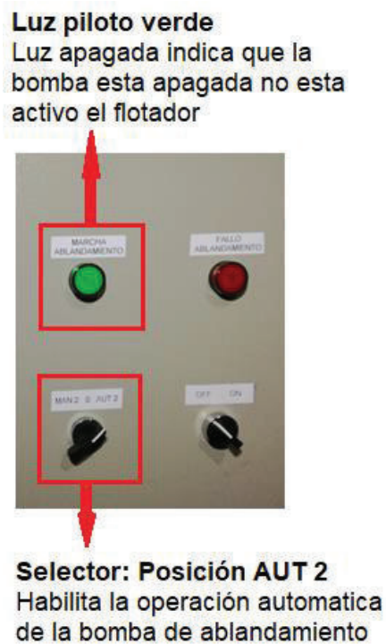
Figura 24. Operación automática de la bomba de ablandamiento
