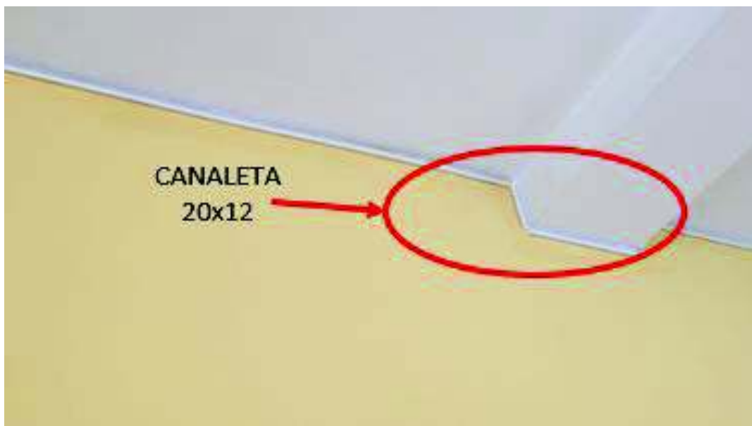
Figura 3. 6 Enrutamiento con canaleta – Riobamba.
