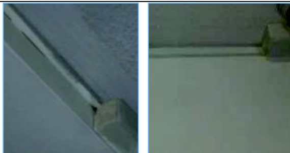
Infraestructura de ruteo
