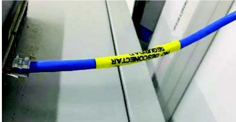
Figura D. 6 Revisión de los conectores y etiquetas del patch cord .
