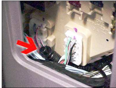
Interruptor manual del sistema de alarma 6
