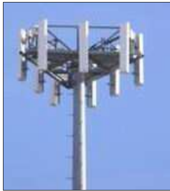
Torre de transmisión de telefonía celular 8
