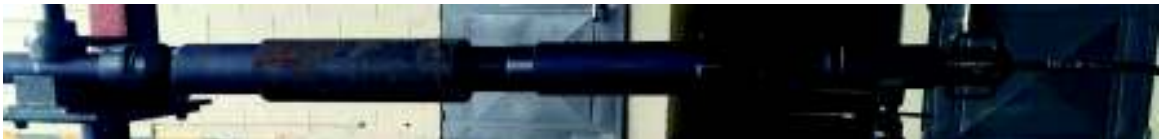
Figura 4.33 Anclaje de cuñas Fuente: Andrade Ismael, 2018
