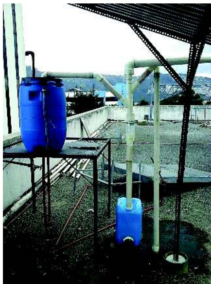
Figura 2.40. Bajante y subsistemas de almacenamiento, saneamiento y acondicionamiento térmico vista posterior.
