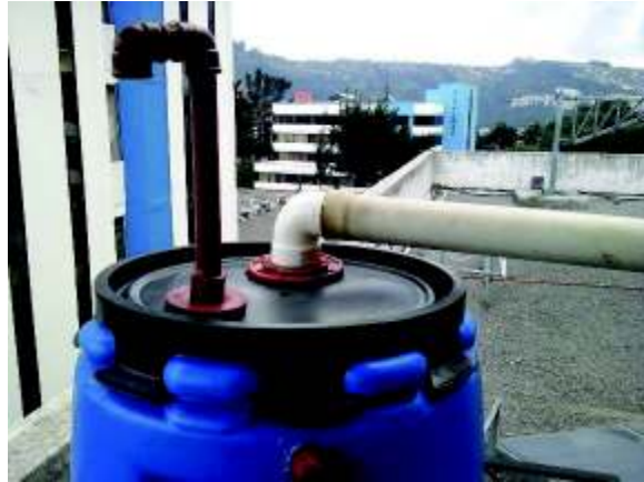
Figura 2.36. Purga de aire y entrada de agua captada.
