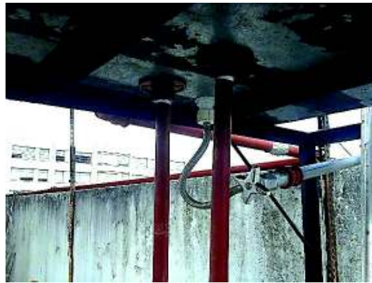
Figura 2.37. Entrada y salida al colector solar plano y entrada de agua del suministro público.
