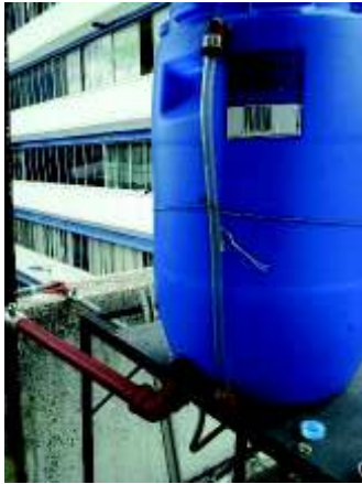
Figura 2.35. Tanque de almacenamiento, visor de nivel y salida a la distribución.
