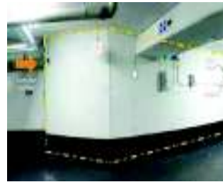
Figura 1.16. Tanque de concreto integrado en la zona de garaje subterránea. Fuente: [20]
