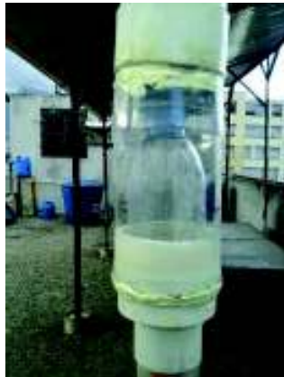
Figura 2.33. Sello del tanque de primeras lluvias.
