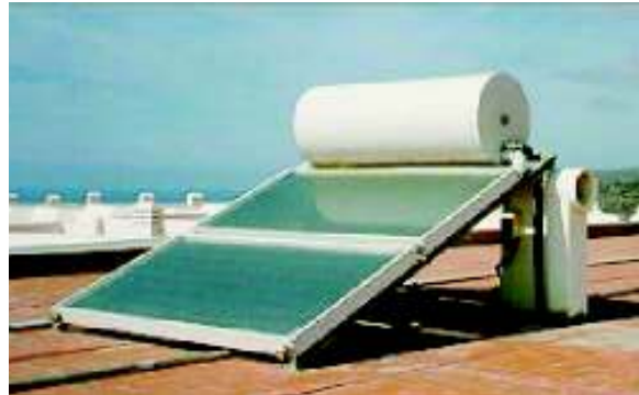
Figura 1.24. Colector solar plano. Fuente: [30]
