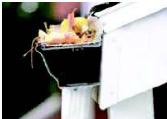
Figura 1.35. Canaleta cubierta con malla para filtración de sólidos. Fuente: [20]
