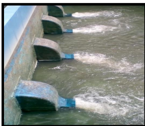
Figura 5.1 Ingresos de agua hacia las unidades de floculación
