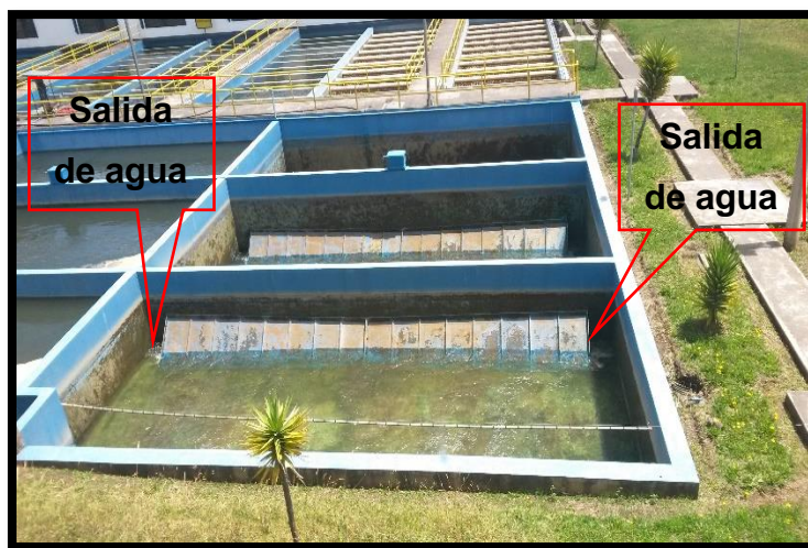
Figura 5.2 Salida de agua entre piscinas de floculación
