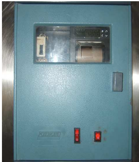
PARTE FRONTAL DEL TABLERO DE SIMULACION
