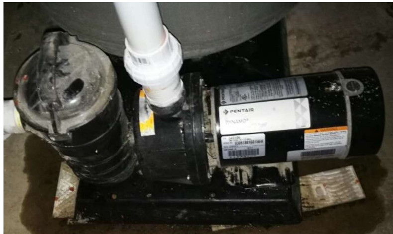
Figura 3.37. Bomba marca Pentair 1/2 HP Circuito Primario Fuente: Propia en domicilio
