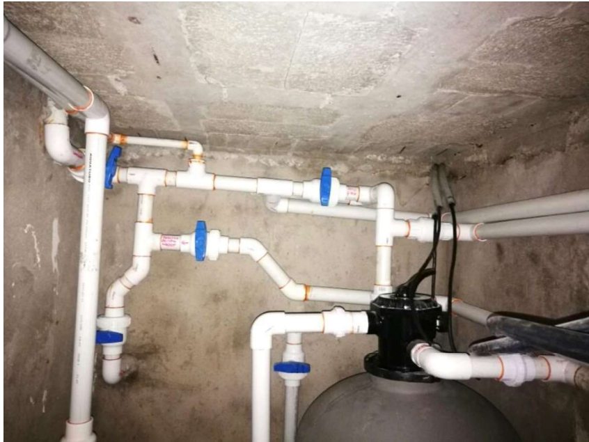
Figura 3.1. Conexiones en el cuarto de máquinas Fuente: Fuente Propia
