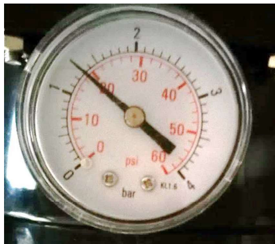
Figura 3.63. Registro de presión del filtro Fuente: Propia en domicilio
