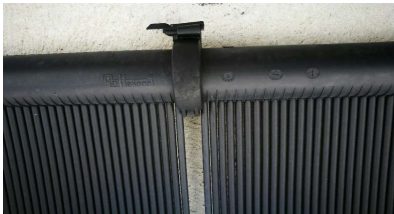
Figura 3.76. Verificación de fugas en juntas de colectores solares Fuente: Fuente Propia
