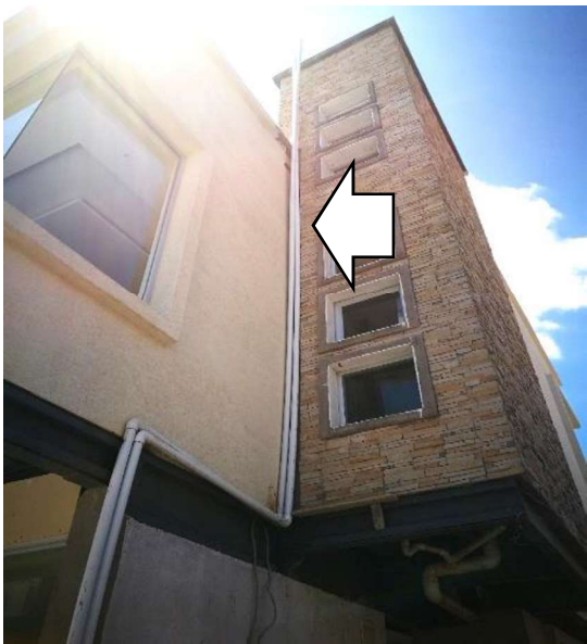
Figura 3.31. Tubería hacia paneles solares Fuente: Propia en domicilio
