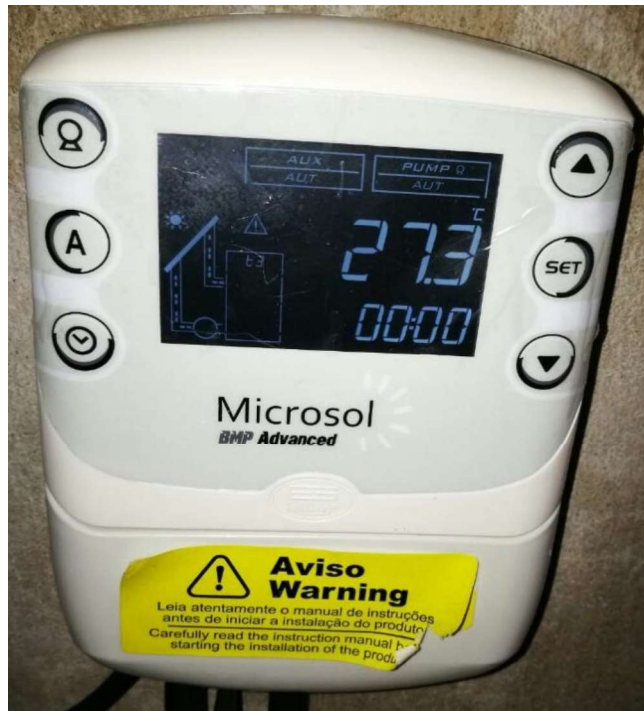
Figura 3.55. Instalación finalizada con temperatura real en tuberías Fuente: Propia en domicilio
