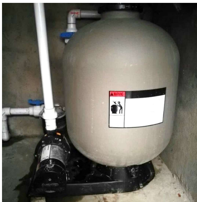
Figura 3.33. Instalación del filtro dentro del cuarto de máquinas Fuente: Propia en domicilio
