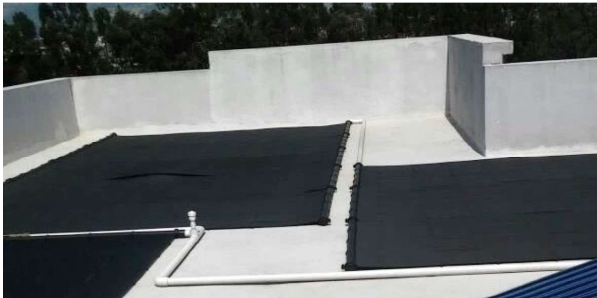
Figura 3.61. Baterías en correcto funcionamiento Fuente: Propia en domicilio
