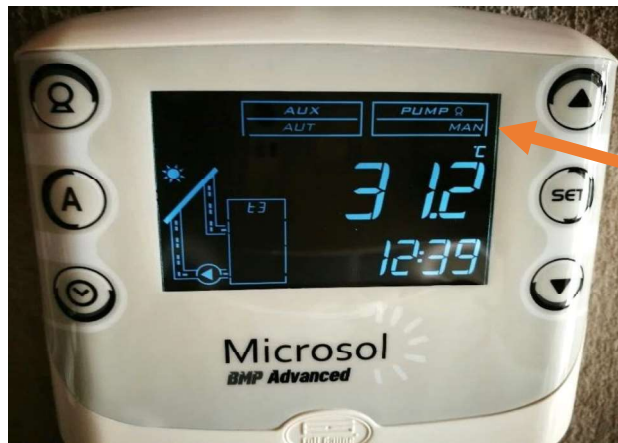
Figura 3.66. Control del circuito principal en modo Manual Fuente: Fuente Propia
