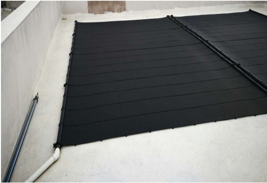
Figura 3.47. Instalación de Colectores solares en serie Fuente: Propia en domicilio
