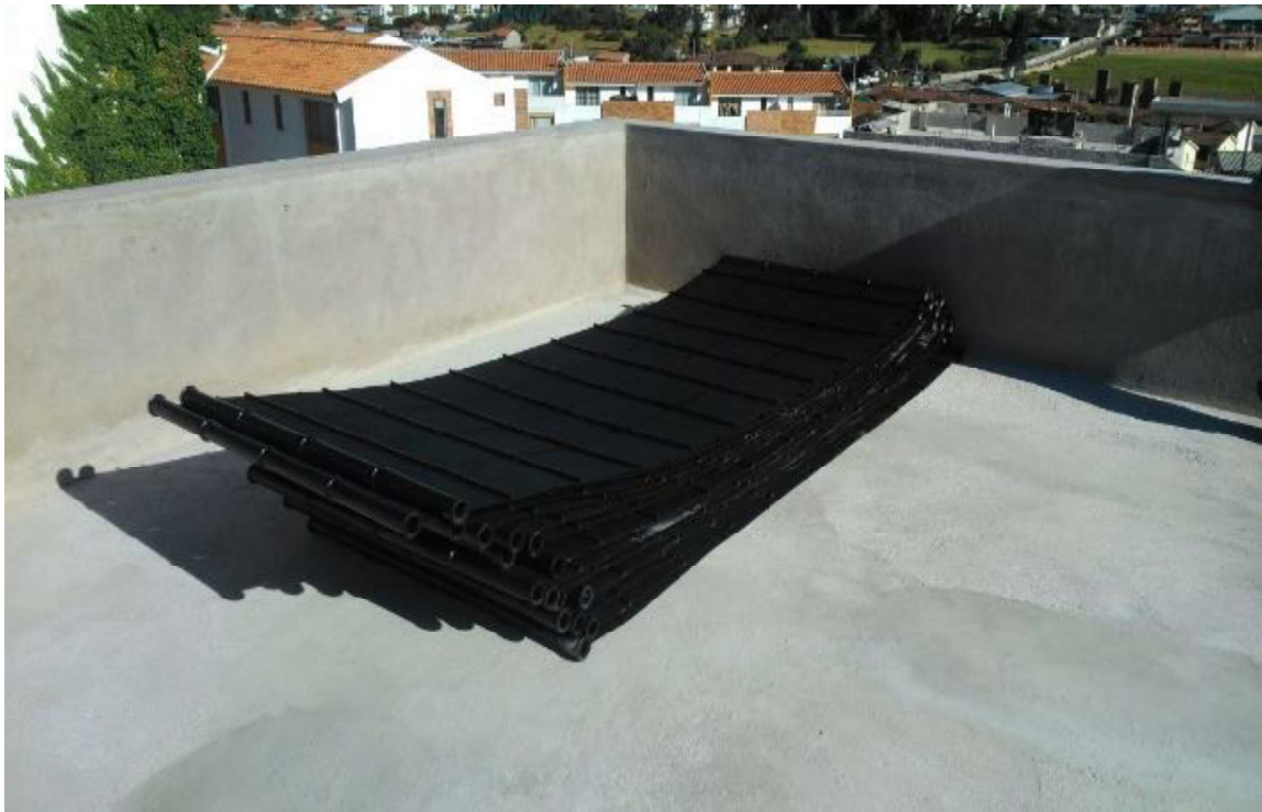
Figura 3.46. Paneles solares Heliocol HC-40 Fuente: Propia en domicilio
