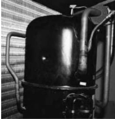
Figura 6.4. Compresor de la Bomba de Calor Fuente: Martínez, F. J. R., & Gómez, E. V, 2005
