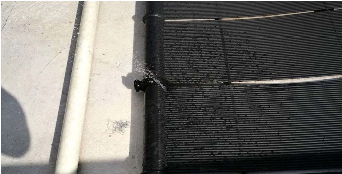
Figura 3.60. Fuga en panel dos de la batería tres del circuito Fuente: Propia en domicilio
