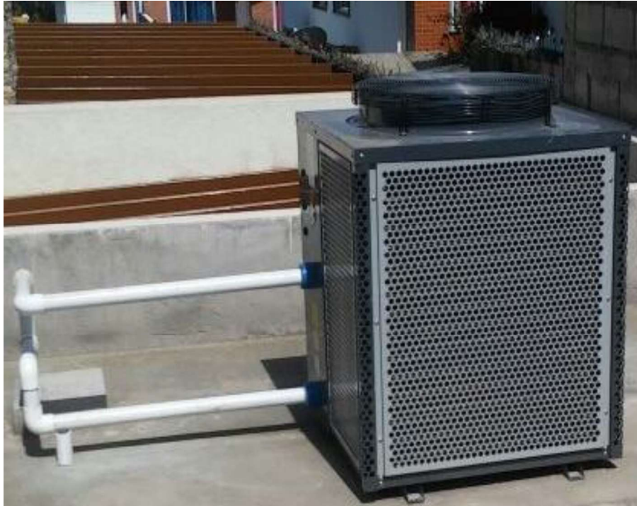
Figura 3.51. Bomba de calor conectada al sistema Fuente: Propia en domicilio
