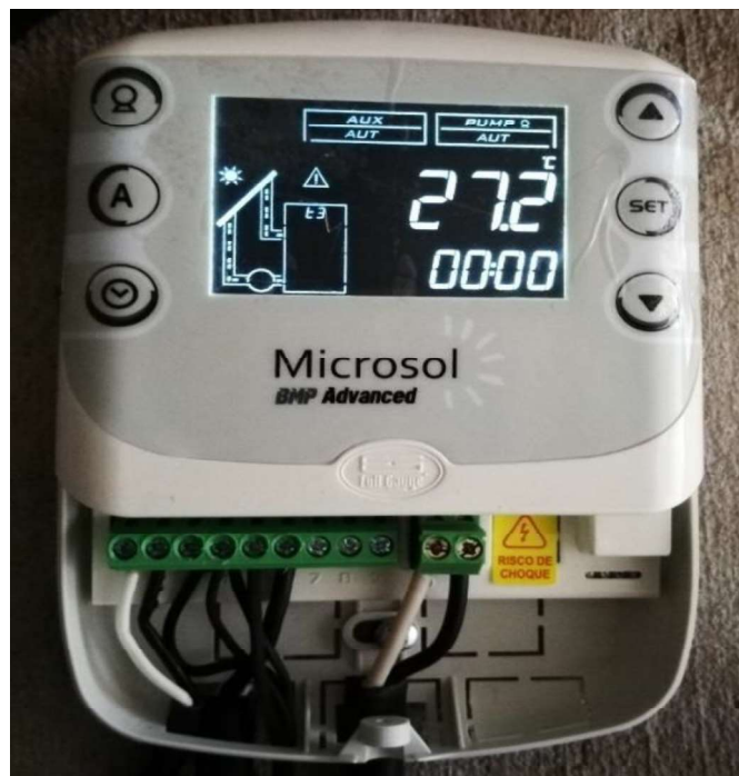
Figura 3.54. Conexión de sensores y bomba al controlador Fuente: Propia en domicilio
