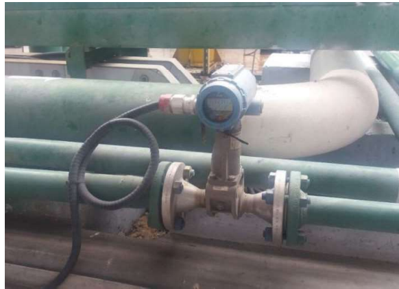
Figura 2.6. Medidor de flujo de gas.
