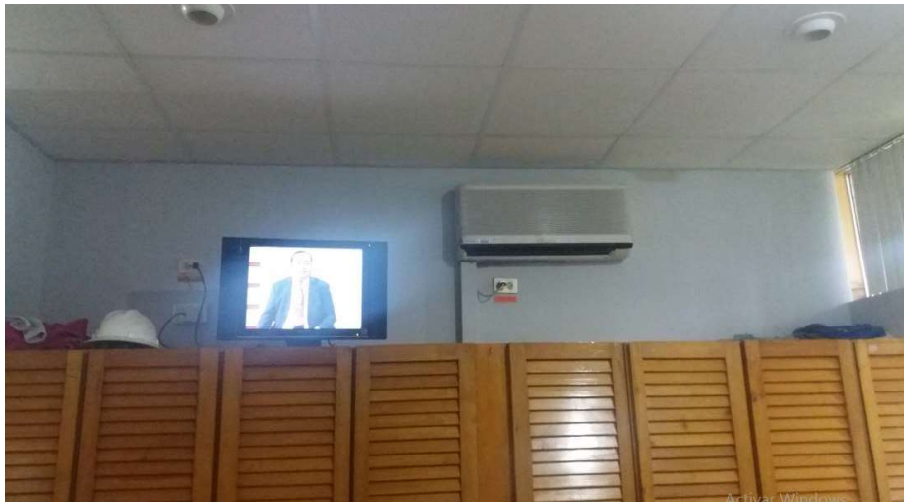
Figura 2.14. Equipos aire acondicionado tipo Split instalados.
