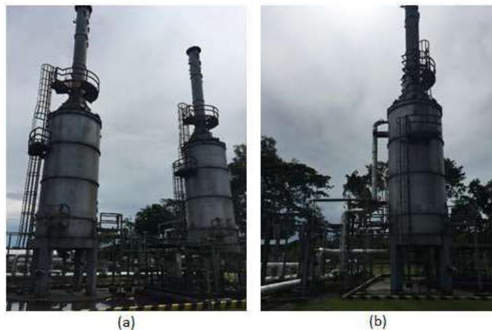
Figura 2.30. a) Vista frontal de los hornos H-320 A/B, b) Vista lateral.
