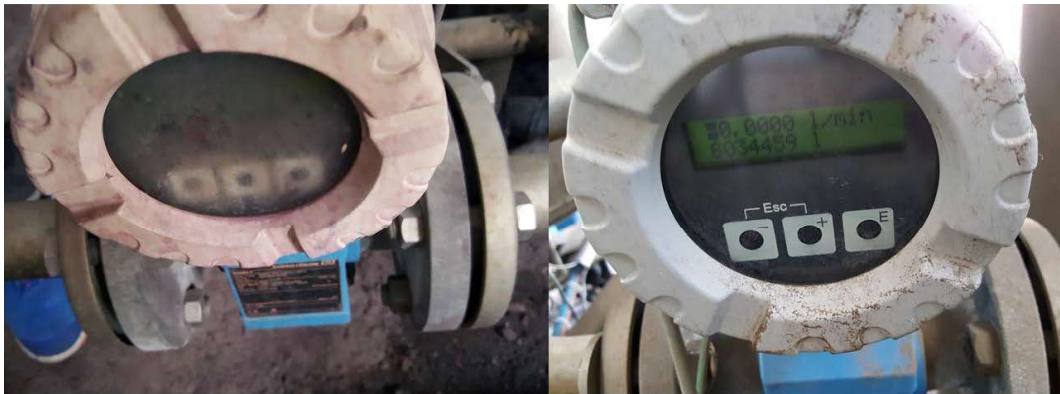
Figura 2.37. Caudalímetros máquinas de tinturación AKM (izquierda), Thies (derecha). (Fuente: Autores)
