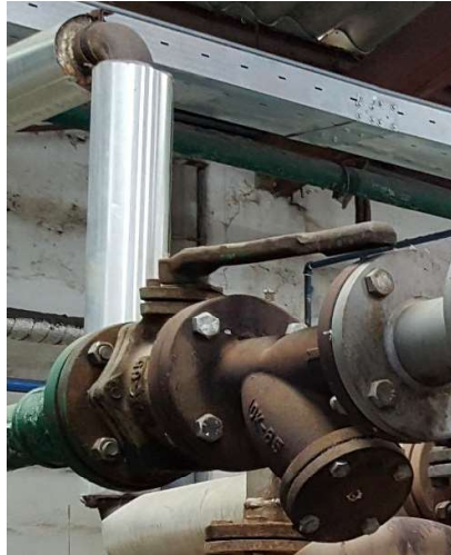
Figura 2.26. Filtro de vapor. (Fuente: Autores)
