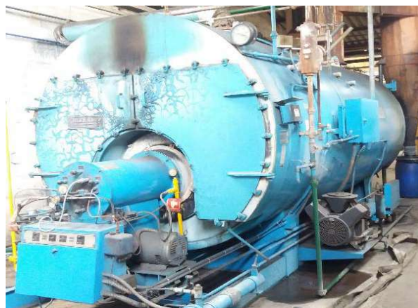
Figura 2.3. Fotografía de la caldera N°2 (Fuente: Autores)
