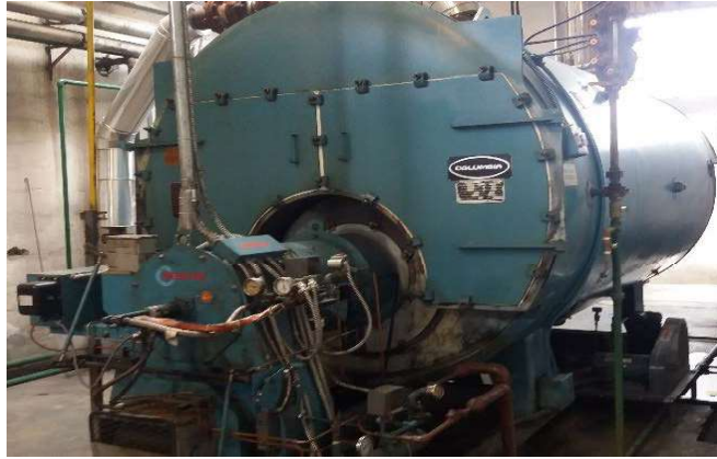
Figura 2.4. Fotografía de la caldera N°3 (Fuente: Autores)
