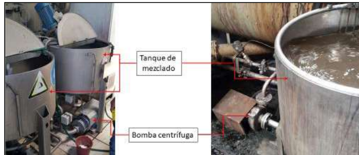
Figura 2.18. Bomba de recirculación de la mezcla en el tanque de mezclado. (Izquierda THIES derecha AKM). (Fuente: Autores)
