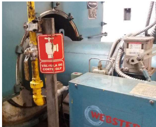
Figura 2.5. Suministro de GLP (Fuente: Autores)
