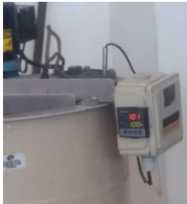
Figura E4. Termocupla de equipo
