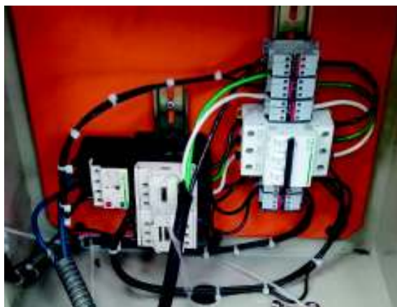
Figura 3. 21. Interior de la caja de control de la baroladora. (Fuente: Propia)
