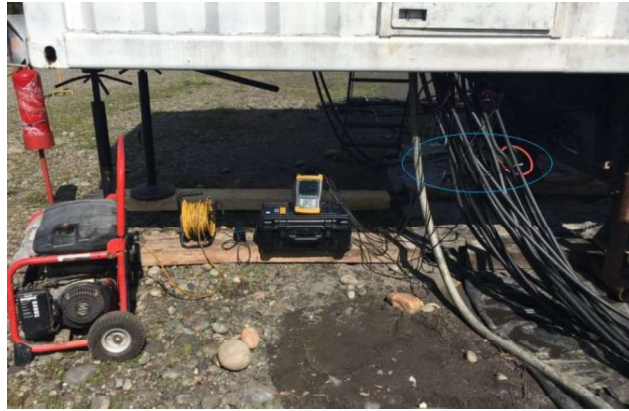
Figura 3.11. Conexión del equipo a la salida del grupo electrógeno. (Fuente: Diego Garcés (fotógrafo), 2017)
