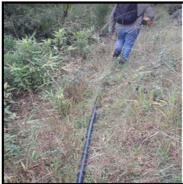
Figura 36. Manguera encontrada al aire libre sector Gallo Canta FUENTE: (El Autor,2018)
