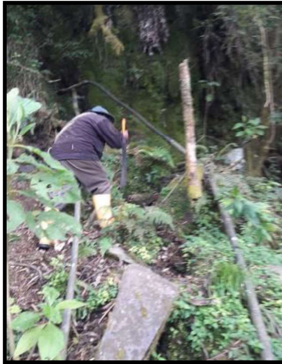
Figura 34. Línea de conducción sector las Abejas a través de mangueras de polietileno fuente 2
