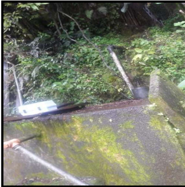
Figura 35. Línea de conducción sector Gallo Canta a través de tuberías FUENTE: (El Autor,2018)
