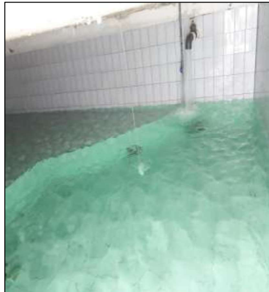
Figura 13 Tanque de Cloración Chaupimolino
