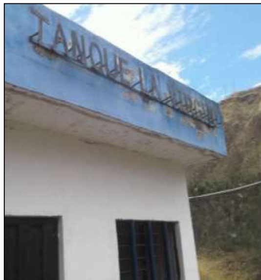
Figura 18 Tanque Cloración La Virginia
