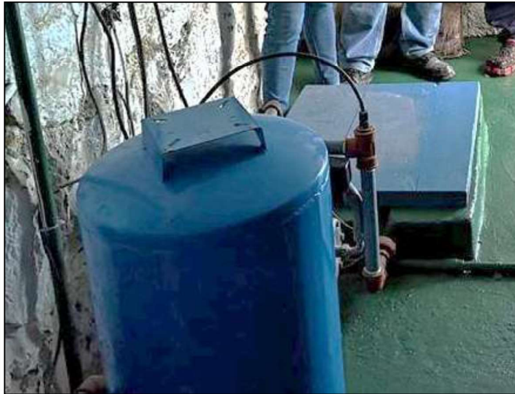
Figura 7 Proceso de cloración por goteo de hipoclorito- Junta Chaupimolino
