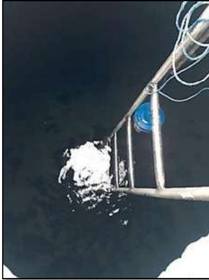
Figura 8 Proceso de cloración por pastillas- Junta Sigsipamba
