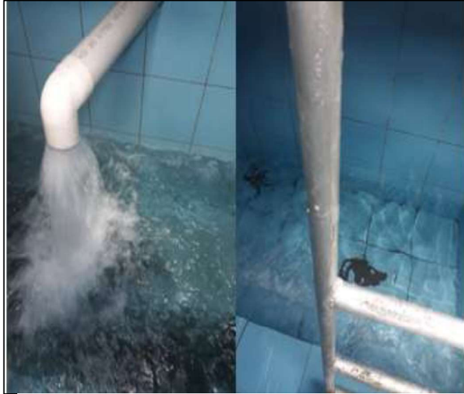
Figura 4 Tanque La Virginia- Presencia de sólidos
