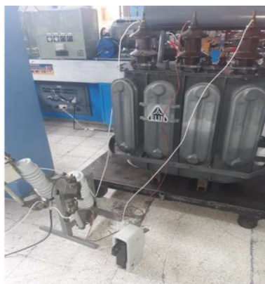
Figura 3.9. Alimentación del transformador trifásico por el lado de alto voltaje.
