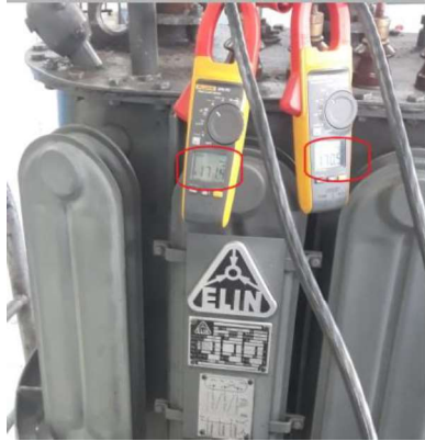
Figura 3.29. Medición de corriente de cortocircuito en las fases donde se produce la falla a tierra.
