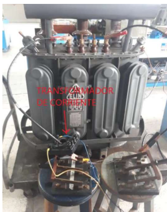
Figura 3.12. Conexión del transformador de corriente en una de las fases a realizar el evento de cortocircuito.
