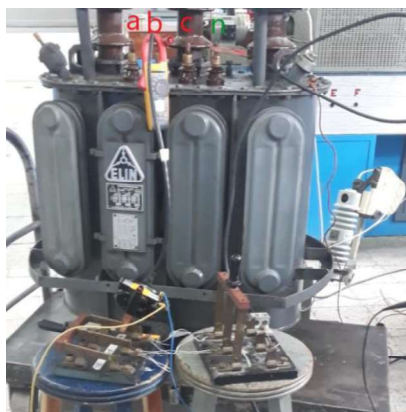
Figura 3.10. Conexión de la fase B para realizar la falla monofásica a tierra.
