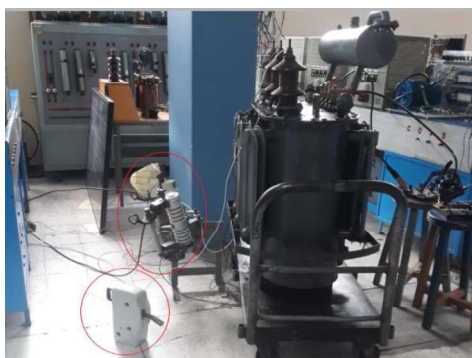
Figura 3.8. Fuente trifásica de 500 [V] con sus seccionadores tipo expulsión.
