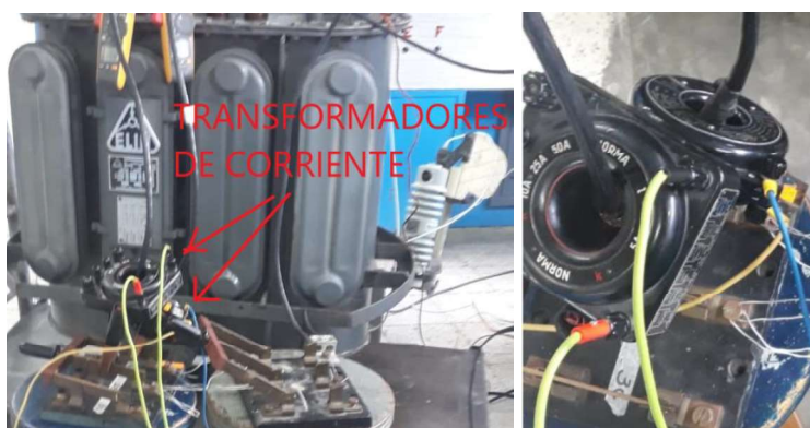
Figura 3.16. Conexión del transformador de corriente en una de las fases a realizar el evento bifásica a tierra.
