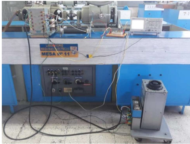
Figura 3.6. Fuente alterna regulable de voltaje para alimentar al transformador bajo prueba.
