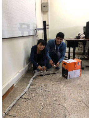
Figura 37 Uso de canaletas
