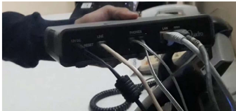
Figura 55 Conexión para puerto FXO Fuente: Central Quadro 2x
