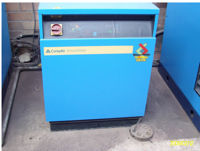
Figura 4.2. Instalaciones de aire comprimido, secador [I.E.P.E.S.A].
