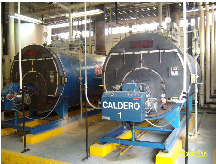
Figura 3.1. Calderas pertenecientes a la Instalación de Vapor del Hospital de Solca Quito.
