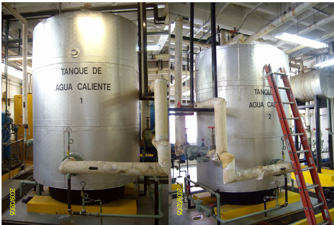
Figura 3.4. Tanques de agua caliente, "Hospital de Solca Quito".
