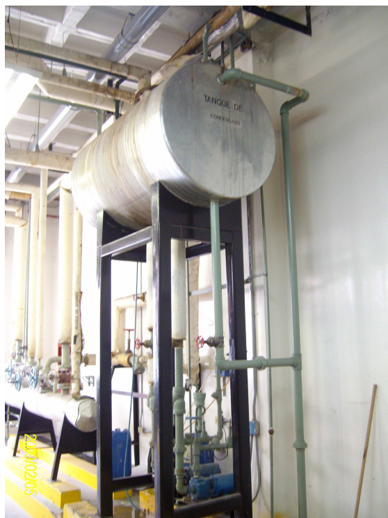
Figura 3.5. Tanques de condensado, "Hospital de Solca Quito".
