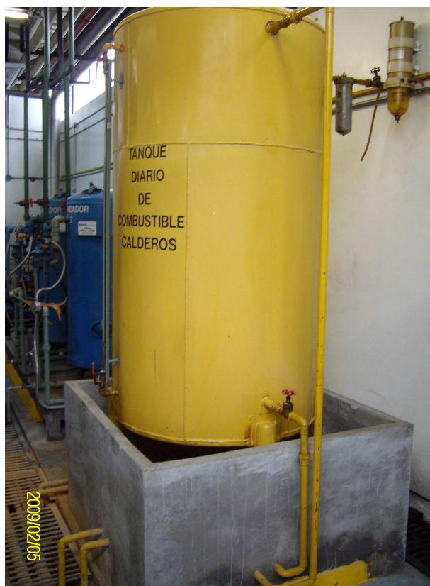
Figura 3.2. Tanque diario de combustible para calderas “Hospital de Solca Quito”.
