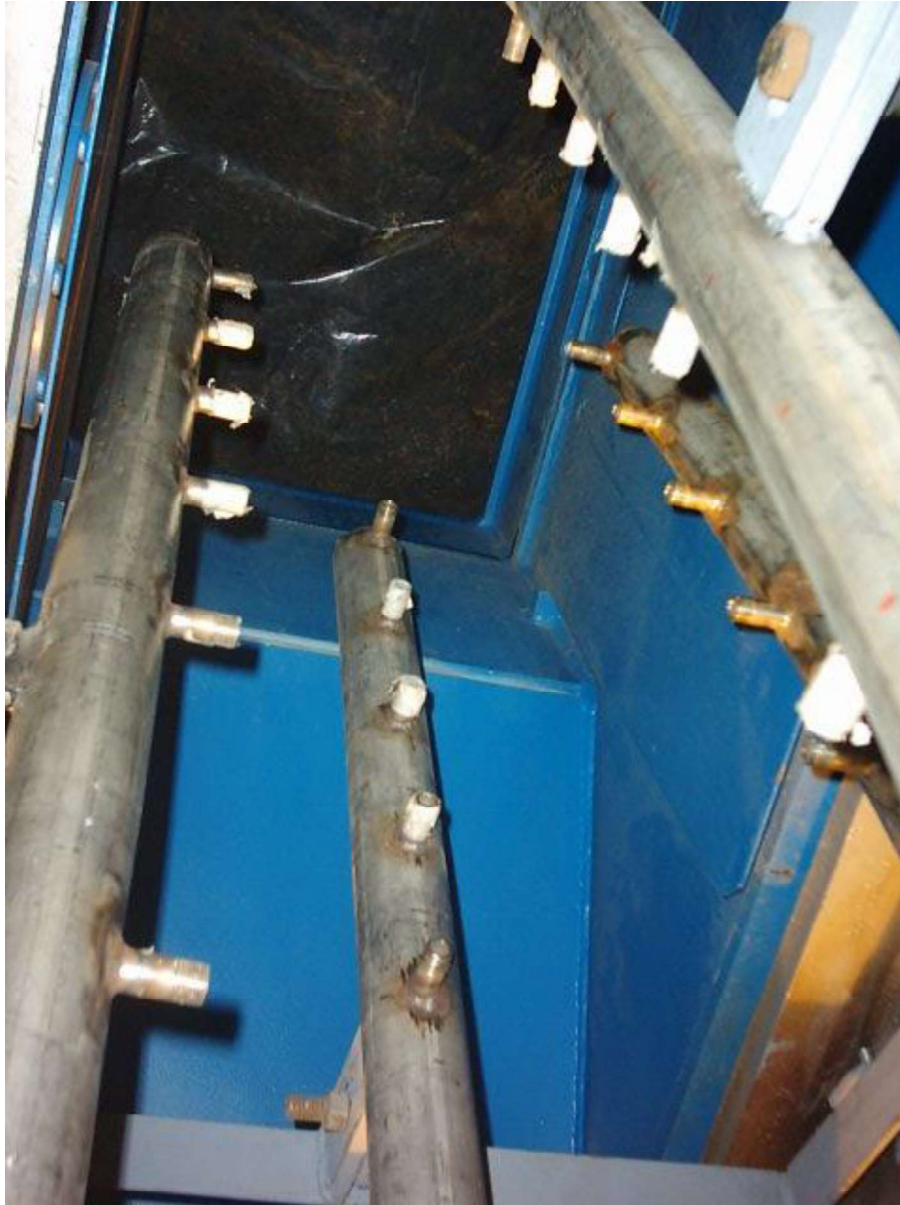
Figura 9. Enfriamiento secundario (flautines)
