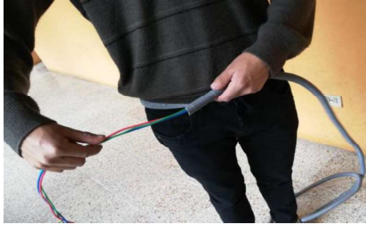
Figura 3.31 Pase de cable eléctrico por manguera plástica corrugada
