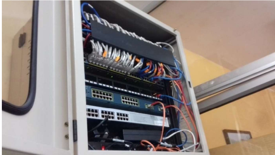
Figura 3.12 Peinado de cables en el rack
