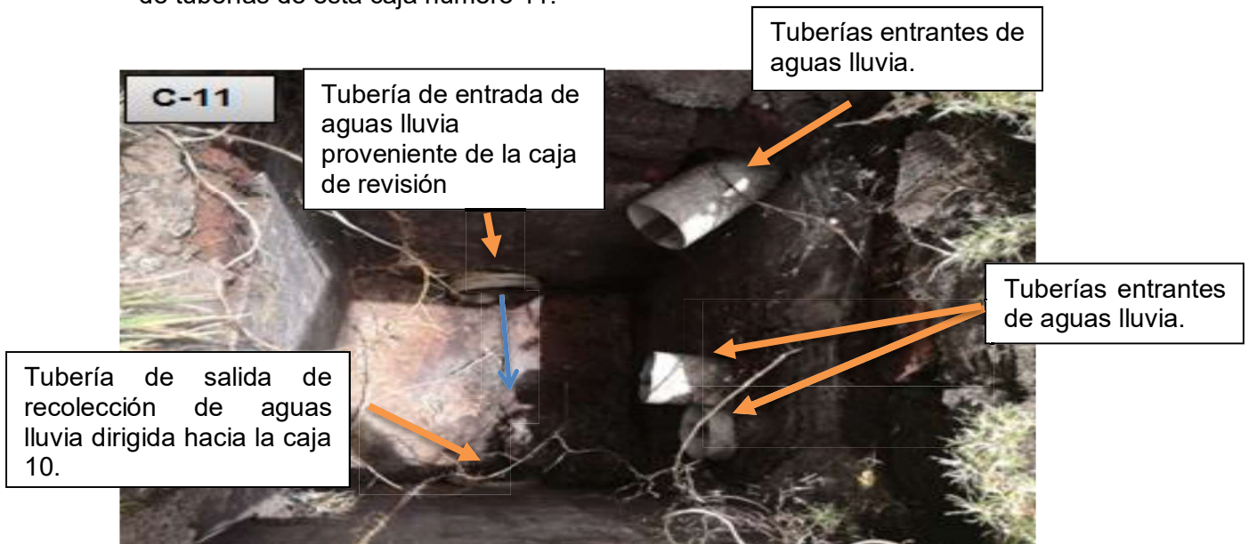
Figura 14 Tuberías de entrada y salida de la caja de revisión 11
