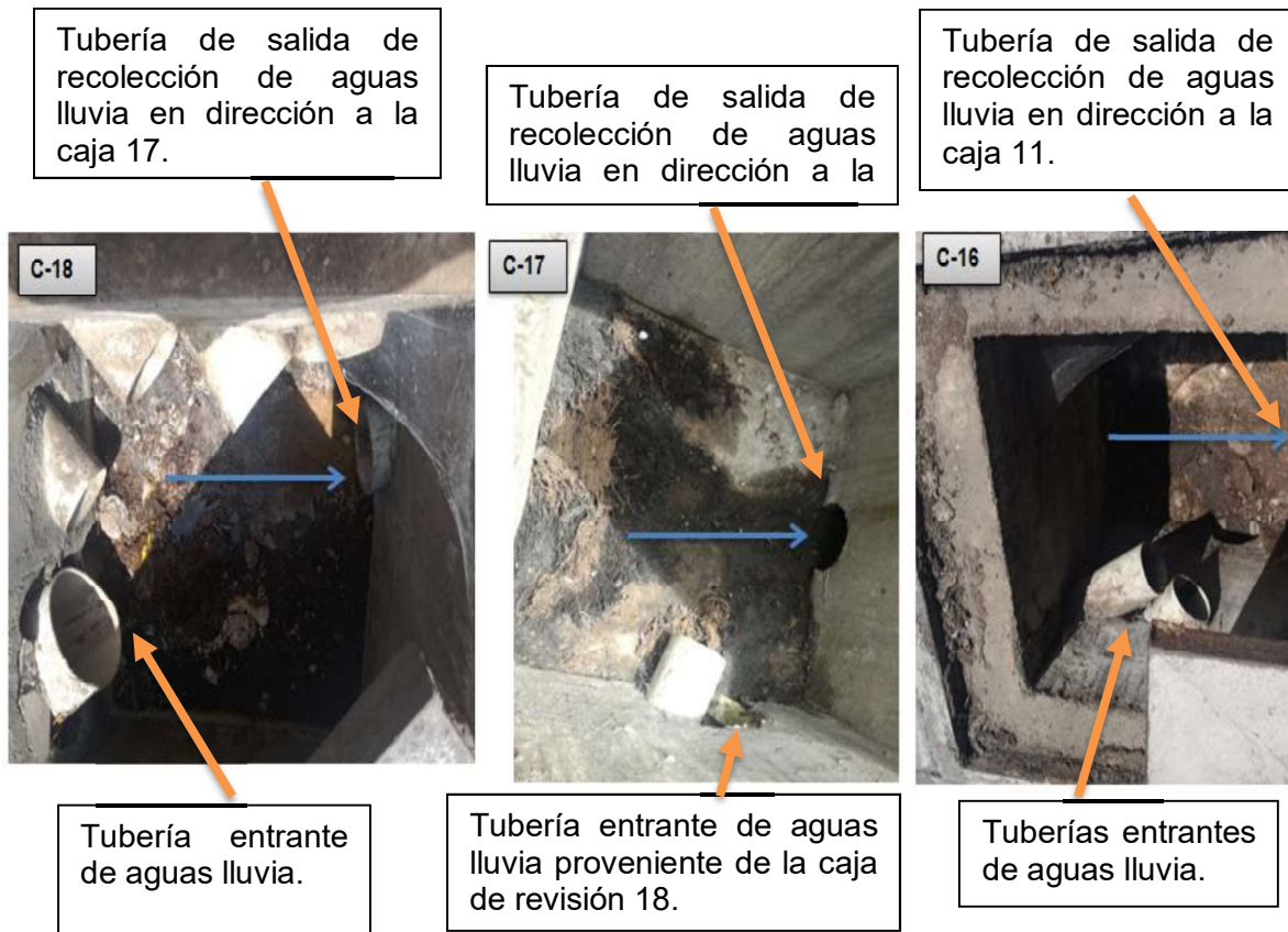
Figura 15 Tuberías de entrada y salida de las cajas de revisión 16,17, y 18
