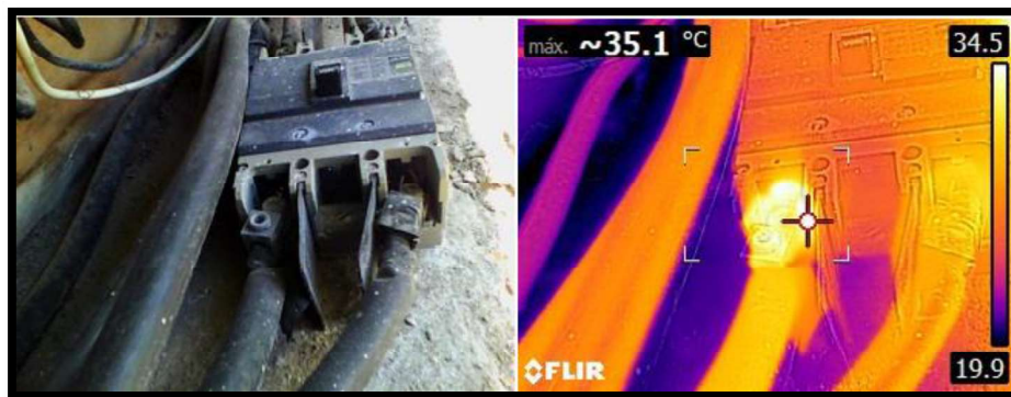
Figura 2.36. Termografía de los conductores del contador de energía principal
