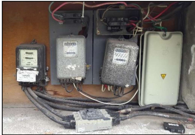
Figura 2.6. Contadores de energía y tablero principal
