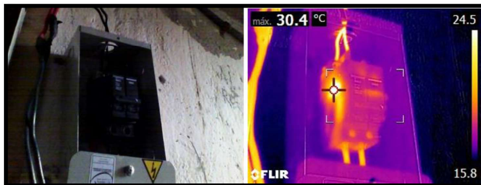
Figura 2.33. Termografía del termomagnético de la piscina.
