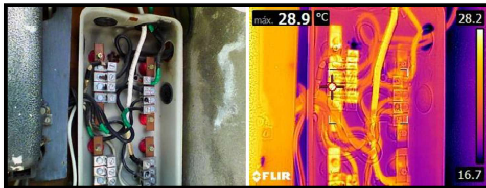
Figura 2.32. Termografía del centro de carga principal
