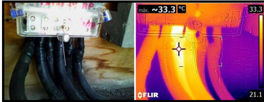
Figura 2.35. Termografía de los conductores de acometida
