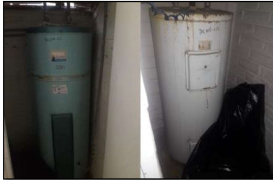
Figura 2.21. Hallazgos encontrados en el área de lavandería
