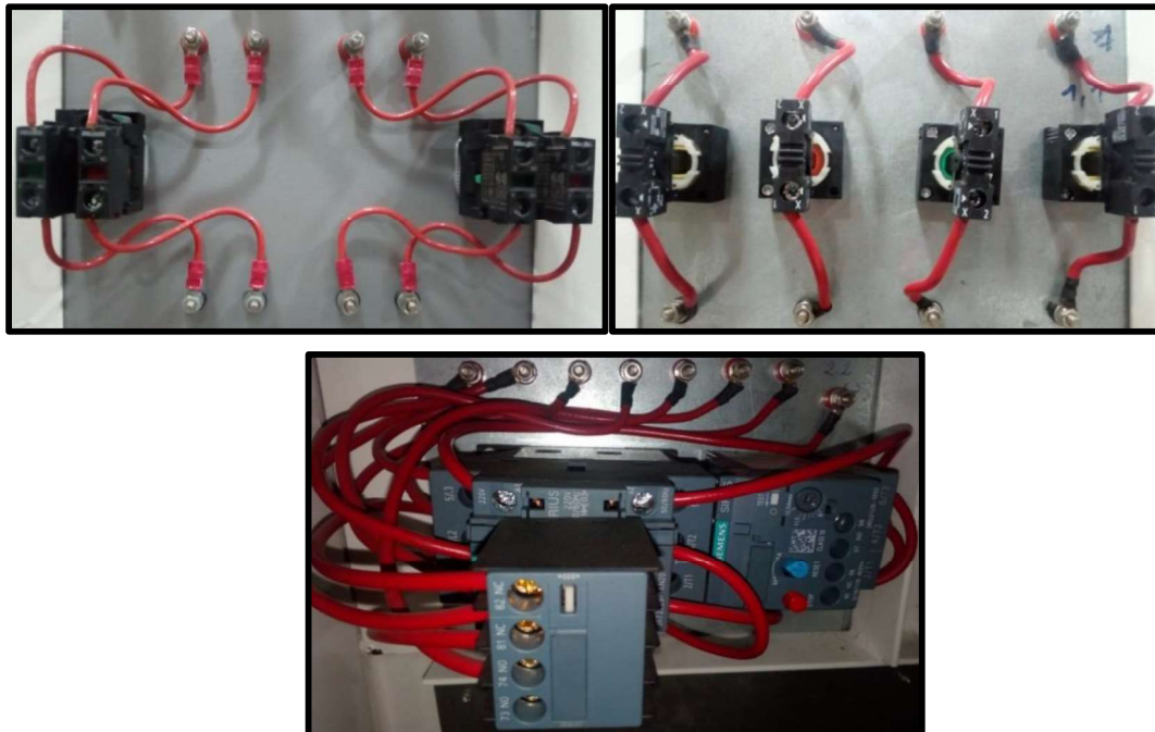
Figura 3.31 Conexión y cableado a los dispositivos.
