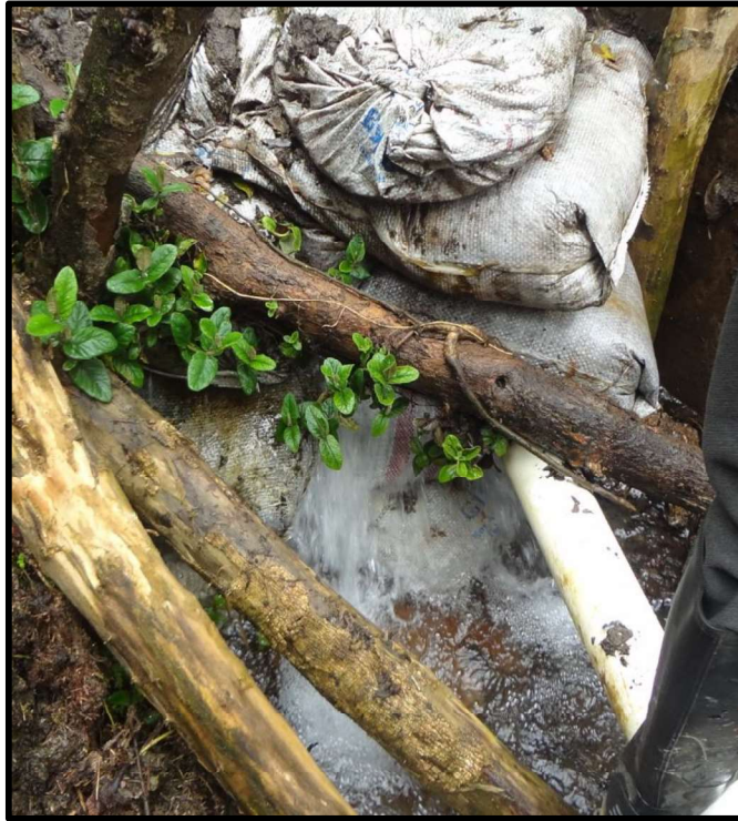
Figura 4.8 Pérdida de caudal en la captación. Fuente: El Autor.
