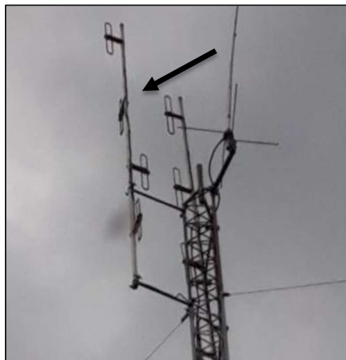
Figura 3.3 Antenas instaladas en la torre
