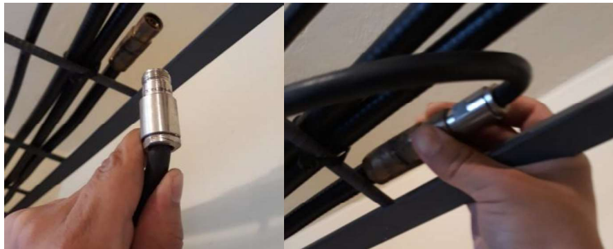
Figura 3.58 Conexión de duplexor a la antena
