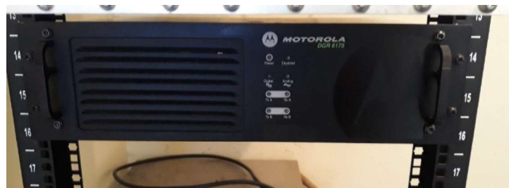
Figura 3.56 Repetidor instalado en el rack de comunicaciones
