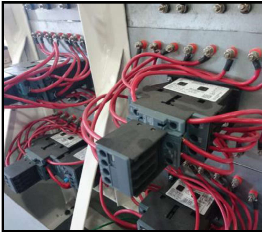
Figura 3.46 Conexión de la placa de los contactores con relés térmicos.
