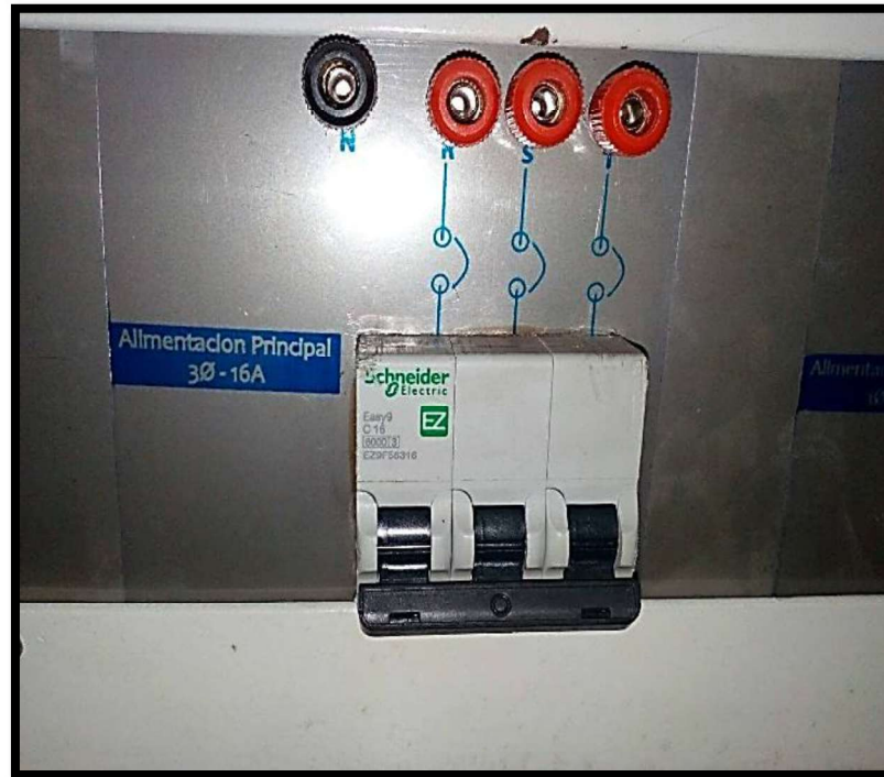
Figura 3.9 Interruptor MCB (Laboratorio de Control ESFOT - EPN).
