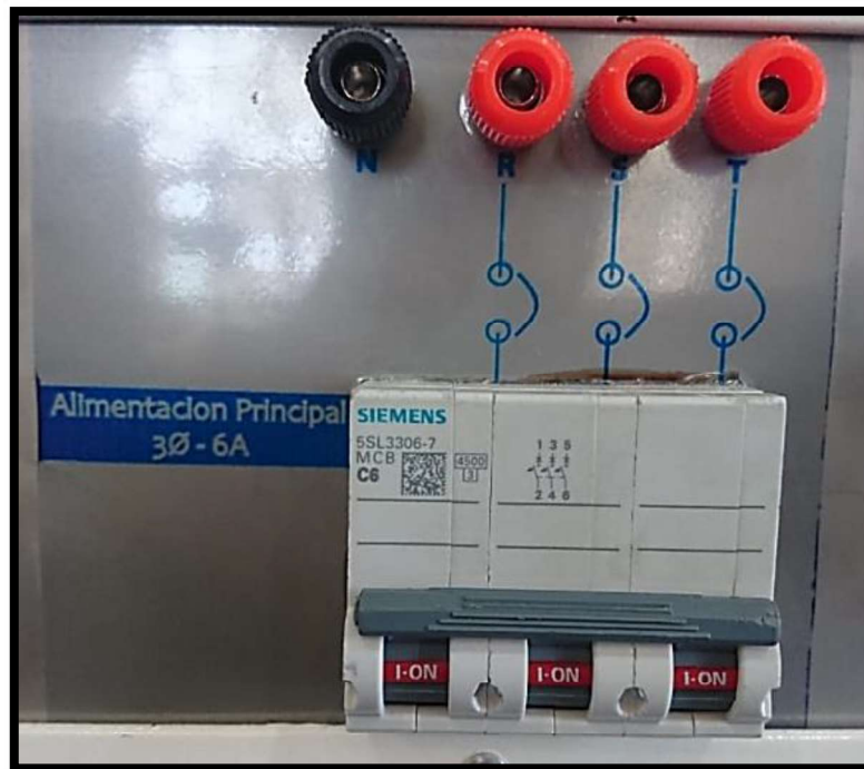
Figura 3.12 Magnetotérmico del circuito de control.
