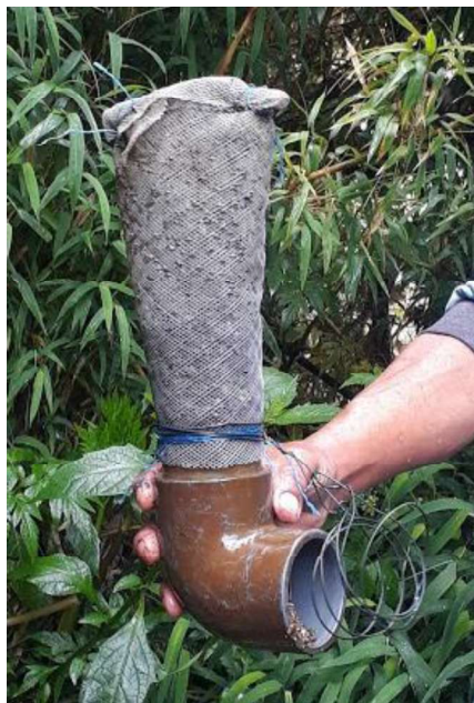
Figura 4. Malla de retención de sólidos en el punto de conexión
