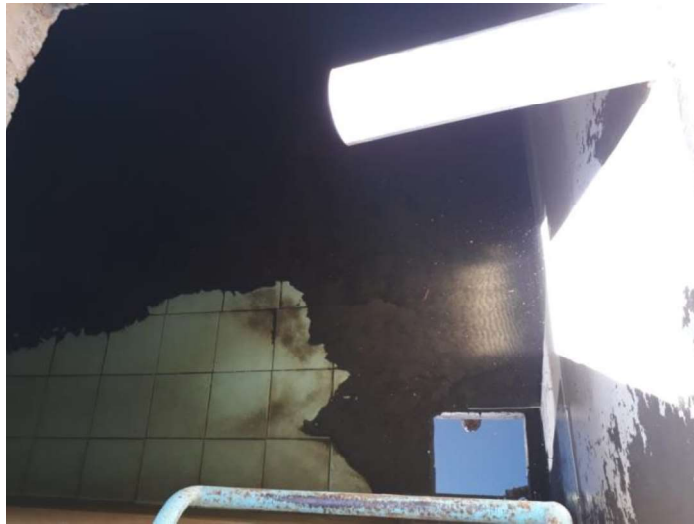
Figura 21. Sedimentos en tanque de almacenamiento
