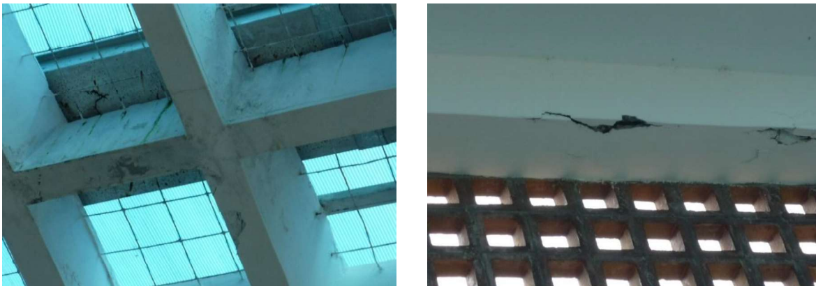
FOTOGRAFÍA 4.2 Daño en elementos estructurales - Bloque administrativo
