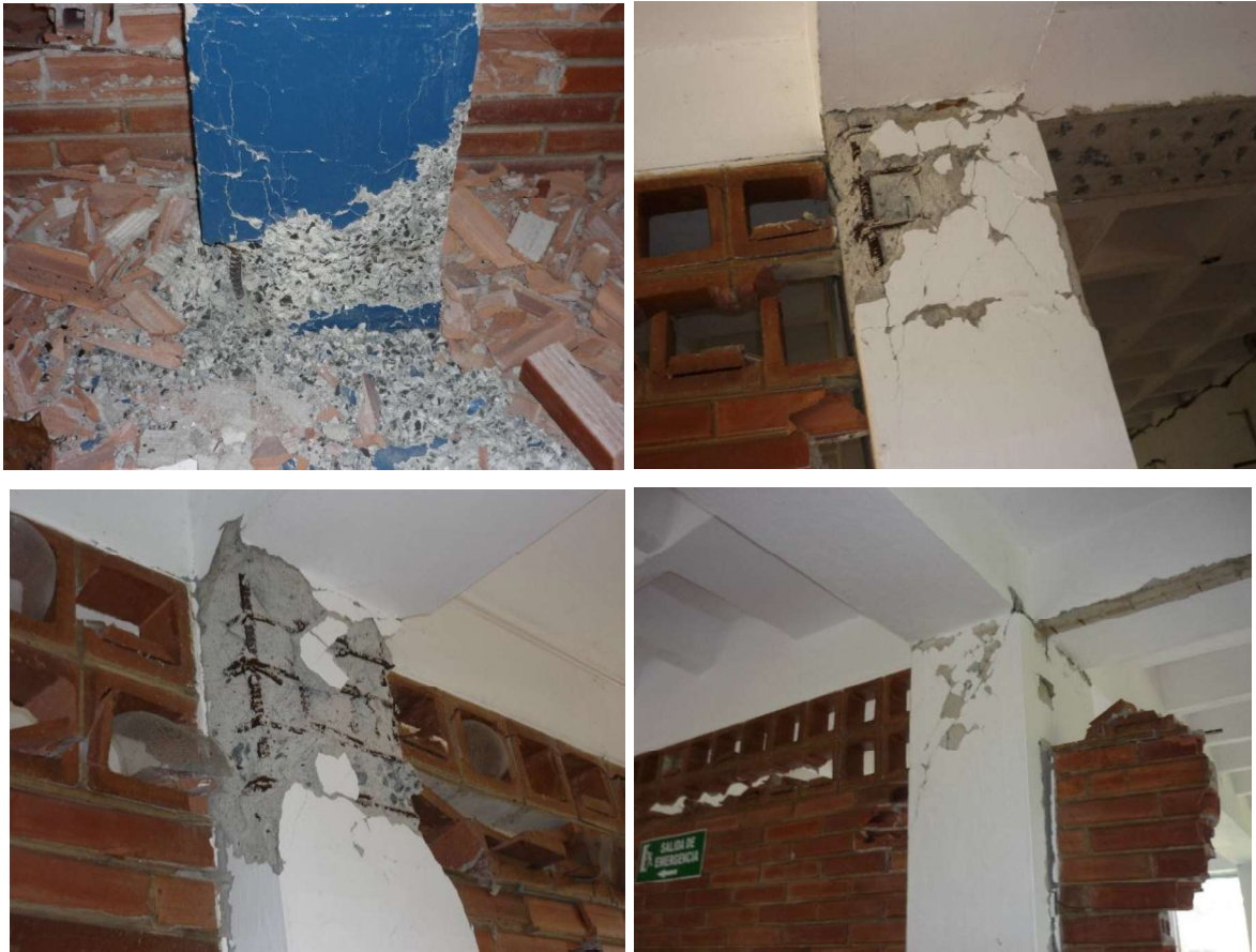
FOTOGRAFÍA 4.4 Daño en elementos estructurales - Bloque B
