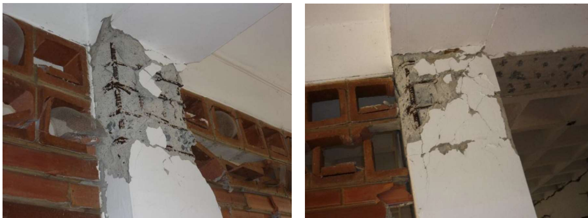
FOTOGRAFÍA 4.5 Efectos de columna corta en el Bloque B
