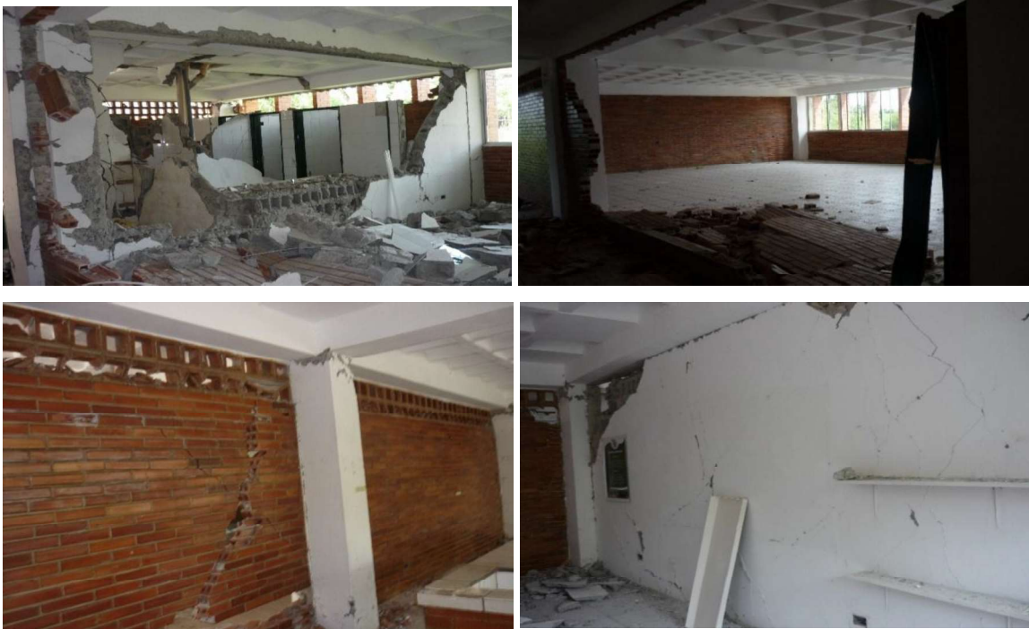
FOTOGRAFÍA 4.3 Daño en mamposterías - Bloque B
