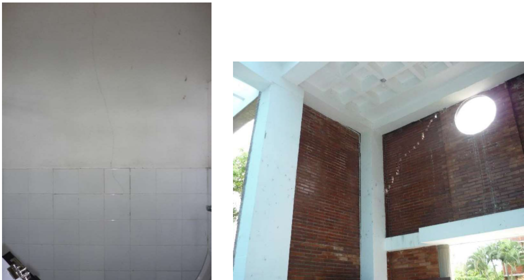
FOTOGRAFÍA 4.1 Daño en mamposterías- Bloque administrativo
