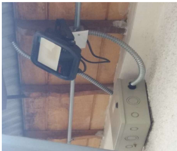
Figura 3.19 Conexión al tablero de control.
