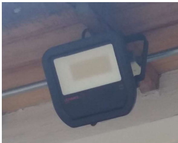
Figura D.11 Luminaria tipo led.
