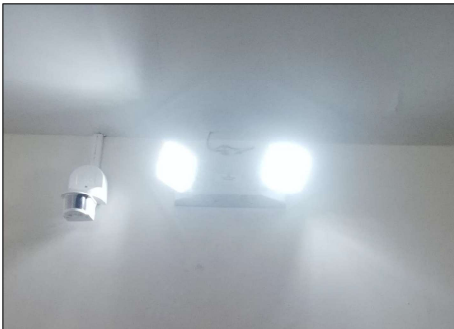
Figura 3.10. Luminaria de emergencia Led. (Fuente: Propia)
