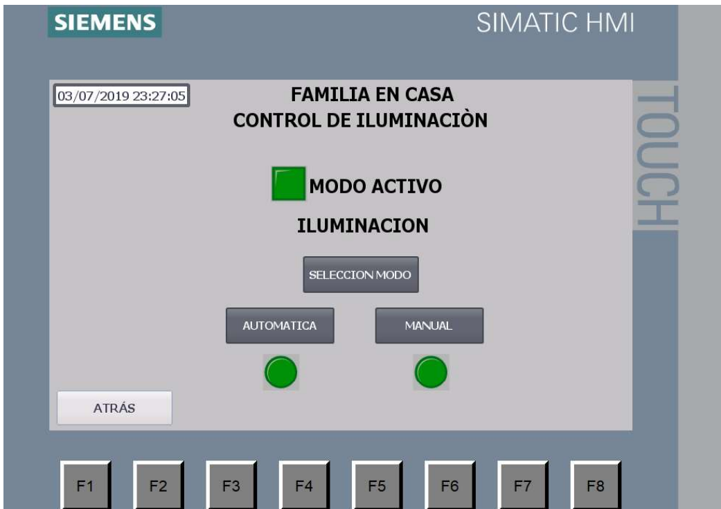
Figura 3.64 Interfaz del control de iluminación en la pantalla táctil
