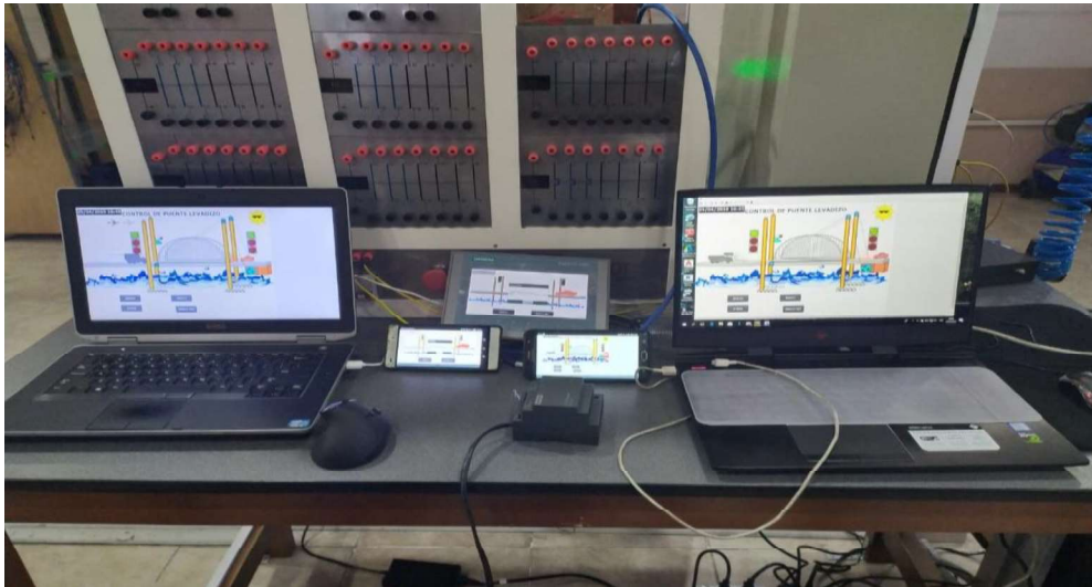
Figura 3.69 Prueba de funcionamiento de dispositivos inalámbricos
