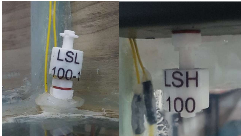
Figura 3. 26 Ubicación de los sensores de nivel
