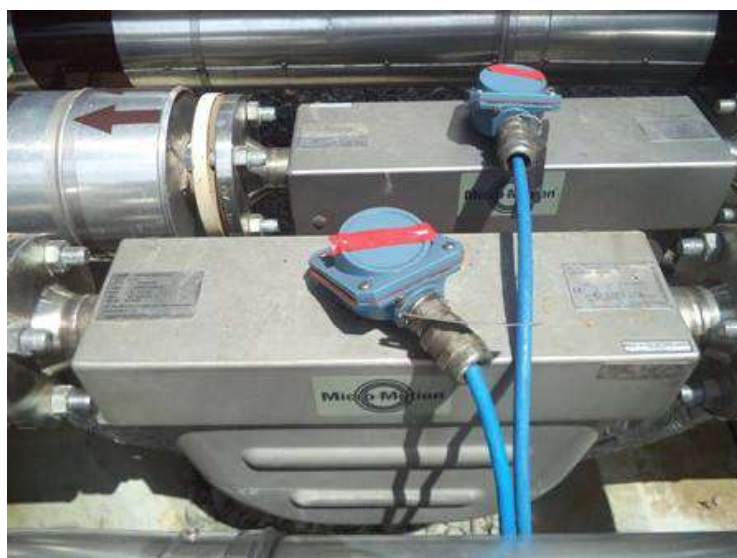
Figura 3.4. Flujómetros de caudal másico de unidades Wartsila W16V32 (Fuente : Departamento Mantenimiento Bloque 18. Petroamazonas)
