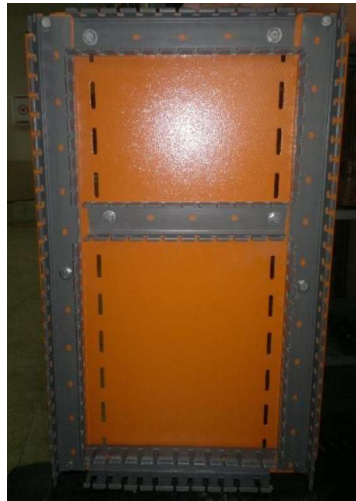
Figura 3.43: Montaje de la riel DIN y canaleta ranurada sobre la superficie electrostática
