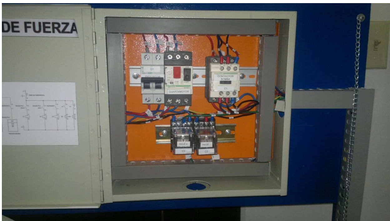
Figura 3.76: Etiquetado gabinete de fuerza
