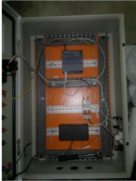
Figura 3.46: Montaje del PLC
