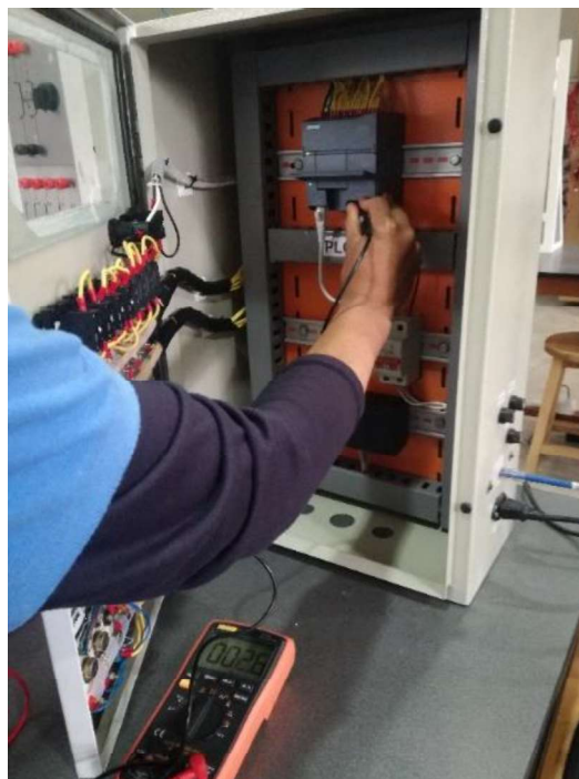
Figura 3.98: Pruebas de conexiones eléctricas en el módulo PLC
