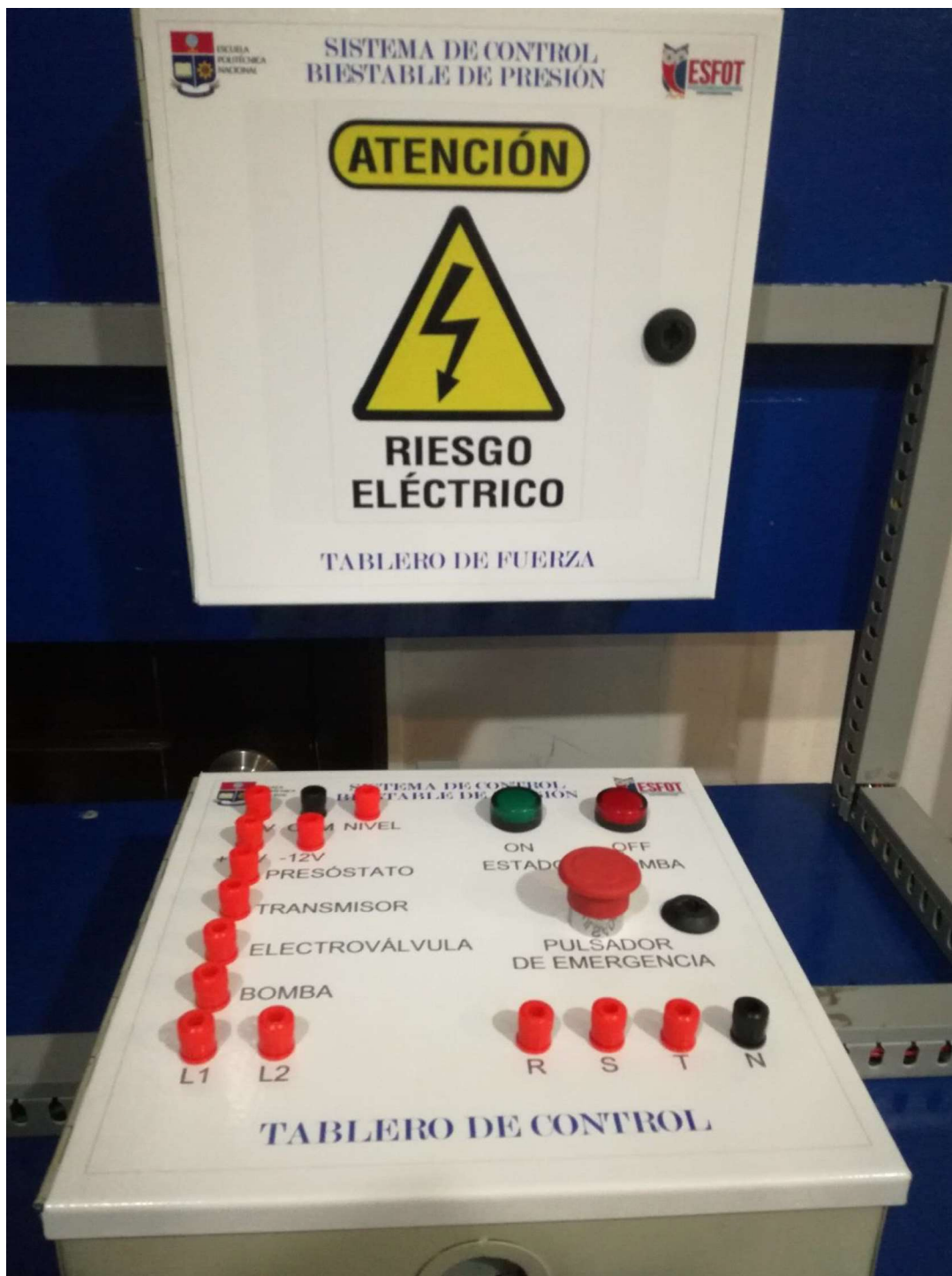
Figura 3.70: Tablero de control y fuerza
