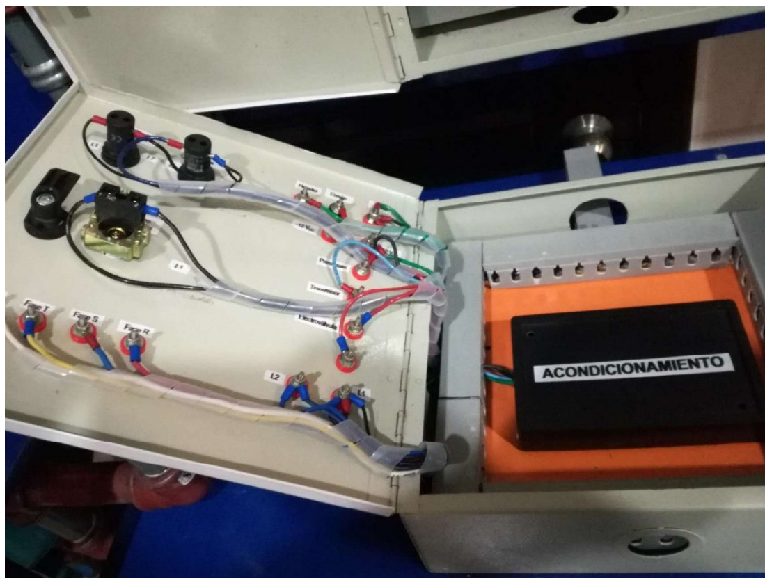
Figura 3.75: Etiquetado gabinete de control
