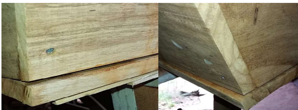
Figura 3.9. Desplazamiento de las tablas de la pared inferior.
