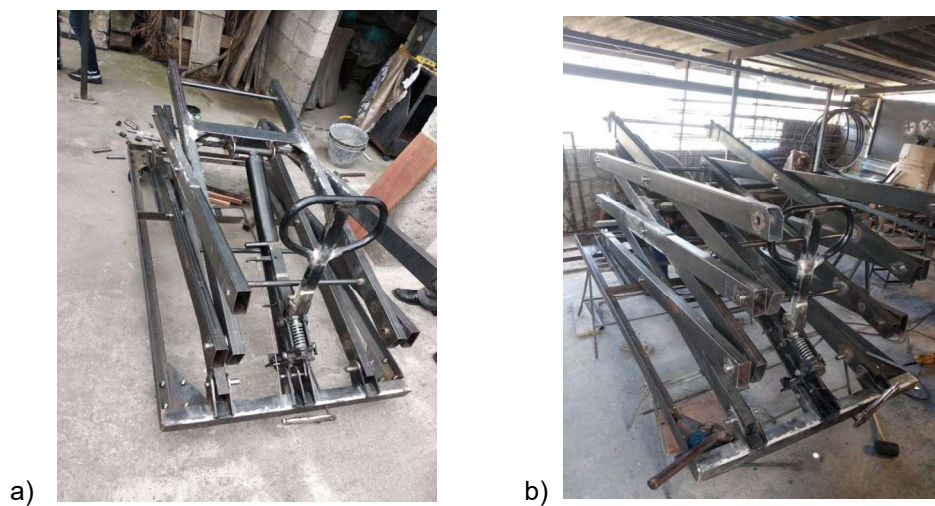
Figura 2.42. (a) Instalación del cilindro hidráulico. (b) Armado del tercer par de tijeras
