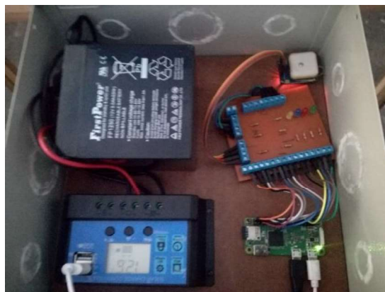
Figura 3.5 Vista interior de la caja de protección.
